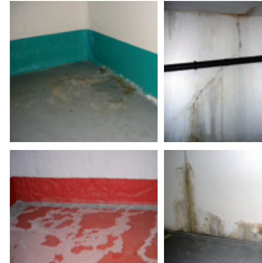
Fissures et conséquences esthétiques.
