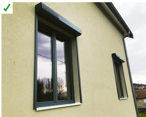
Les volets roulants sont fixés au nu extérieur de l'ITE avec des accessoires adaptés. Le pont thermique est ainsi évité. ©AQC
