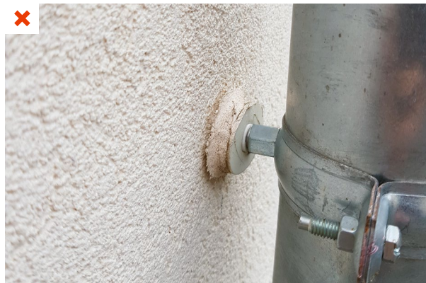
La fixation du collier dans l'ITE est légèrement arrachée et bouge. L'étanchéité à l'eau et le maintien de la gouttière ne sont plus assurés. ©AQC
