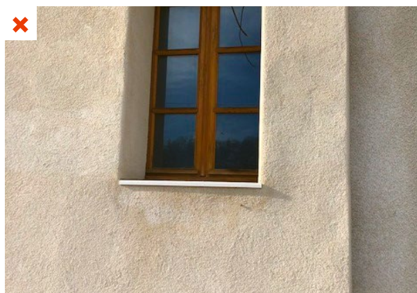
L'isolation par l'extérieur de cette maison s'arrête au niveau du mur mitoyen séparant les deux propriétés. Aucun retour d'isolant par l'ITI n'a été prévu sur ce mur. ©AQC
