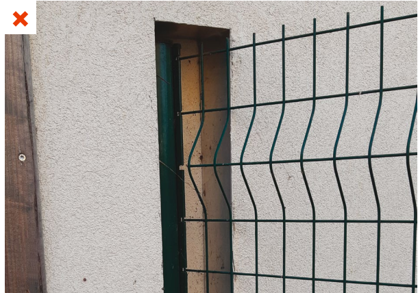
L'interruption de l'ITE au droit du poteau de fixation de la clôture engendre un pont thermique. ©AQC
