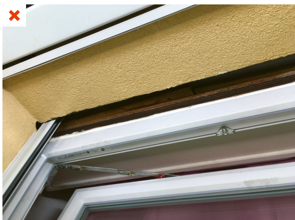
Pont thermique par le caisson de volet roulant extérieur non isolé et situé derrière l'ITE. ©AQC
