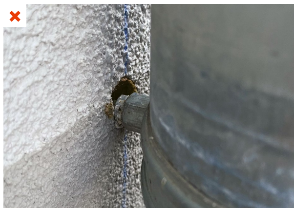
Les fixations des descentes d'eau pluviale traversant l'ITE ne sont pas adaptées. La tenue mécanique insuffisante entraîne une dégradation de l'isolant et la création d'un pont thermique. L'étanchéité à l'eau n'est plus assurée. ©AQC
