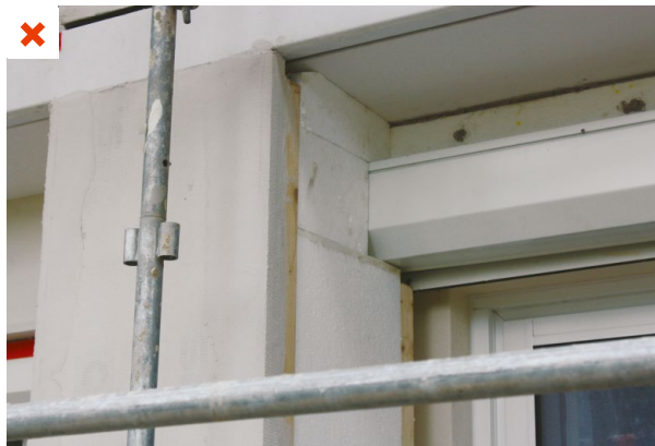
Pont thermique sur toute la longueur du coffre de volet roulant et maintenance impossible sans démontage localisé de l'ITE en appui du coffre. ©AQC
