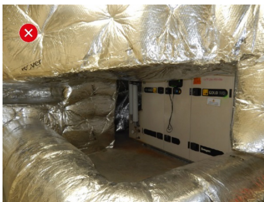
Le cheminement et l'encombrement du réseau aéraulique empêchent un accès aisé à la CTA.
