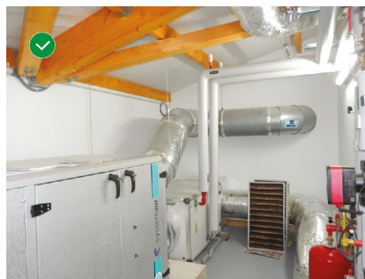
L'accès à la CTA est aisé, l'intervention est donc possible sur l'ensemble des équipements du système.
