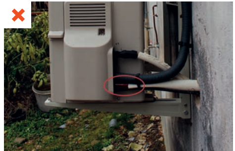
L'isolation du réseau frigorifique est incomplète. Elle s'interrompt avant d'arriver au droit de l'unité extérieure. En outre, la traversée du mur par les réseaux n'est pas étanche. ©AQC
