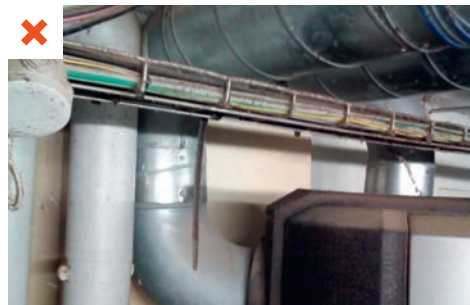
Des câbles électriques cheminent au-dessus du CET et entravent le changement du filtre qui se fait en déployant la partie haute. ©AQC
