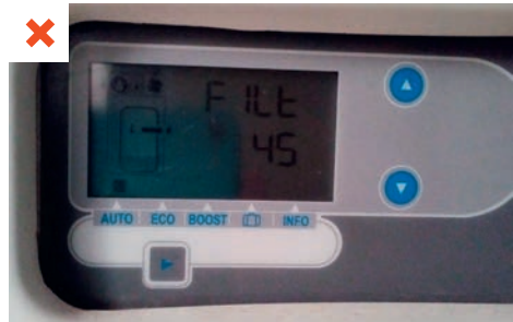
Le panneau d'affichage montre la saturation du filtre de la pompe à chaleur avec l'erreur « FILTE ». Aucune intervention n'est prévue ni programmée. ©AQC
