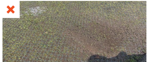
Disparition de la végétation mise en place du fait d'un défaut de drainage et d'un écrasement de la végétation par les véhicules. Le remplissage des alvéoles est trop important. ©AQC
