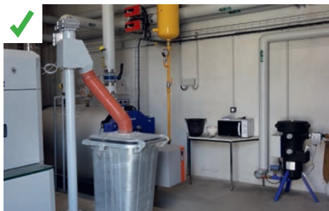
Installation d'un poste de contrôle d'humidité des plaquettes dans le local chaufferie composé d'un micro-ondes et d'une balance type pèse-lettre. ©AQC
