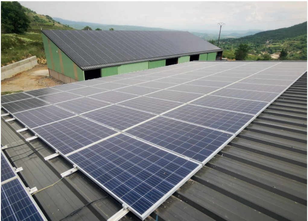
Centrale photovoltaïque posée en surimposition sur les bacs acier de toitures agricoles.
