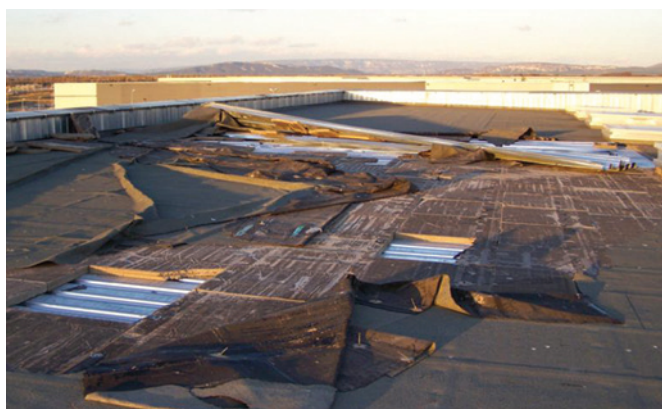
Figure 10 : Sous-dimensionnement des fixations de la membrane d'étanchéité au regard de l'exposition du site au vent (soulèvement de 250 à 300 m 2 d'étanchéité ainsi qu'arrachement de 3 bacs métalliques supportant le complexe)
