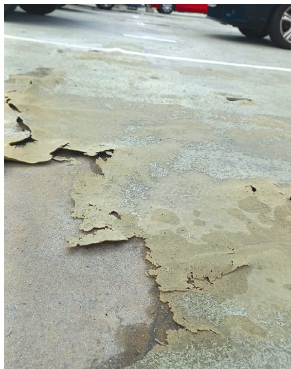
Figure 23 : Revêtement dégradé par la circulation des véhicules.
