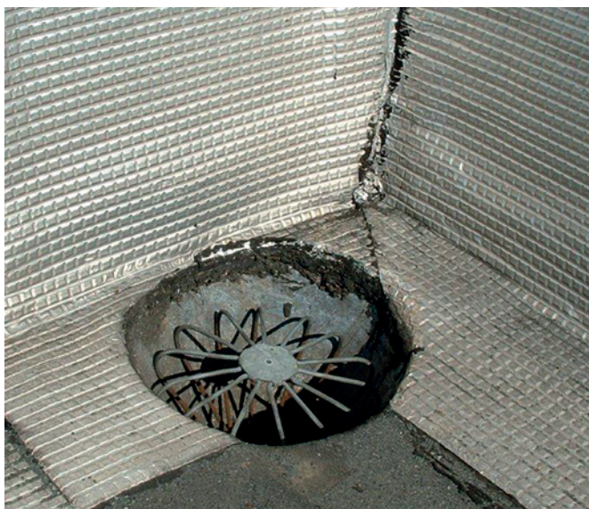
Figure 67 : Crapaudine trop petite pour le diamètre de l'EEP, ce qui va favoriser l'accumulation des feuilles et des débris au droit de l'EEP
