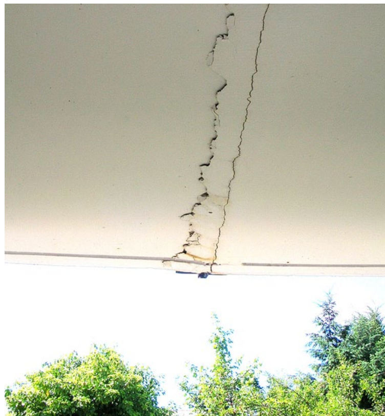
Fissuration en l'absence de joint de fractionnement d'un balcon (Crédit photo : Sacobat)
