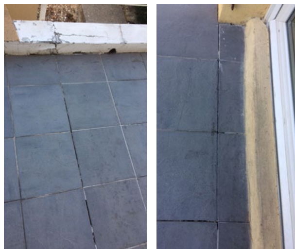
Dégradation des joints de carrelage liée à une insuffisance de pente (Crédit photo : Eurisk)
