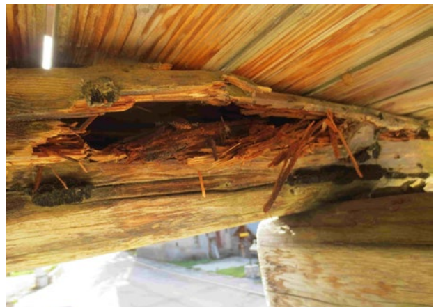
Dégradation de structure porteuse de balcon en bois par attaque (Crédit photo : Saretec)
