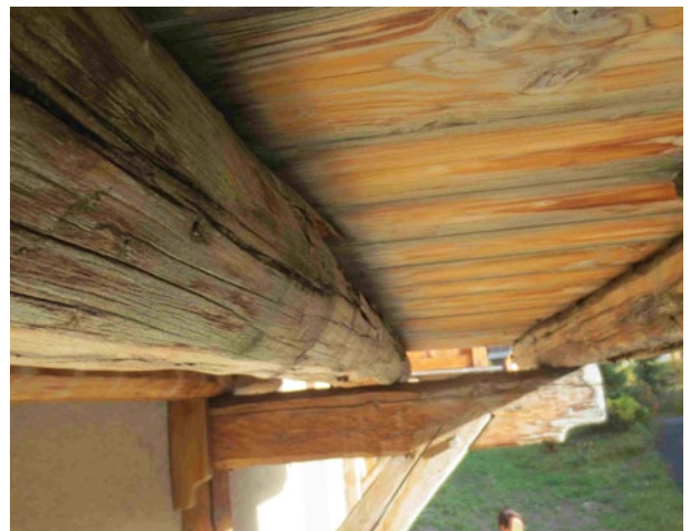
Dégradation de structure porteuse de balcon en bois par attaque (Crédit photo : Saretec)
