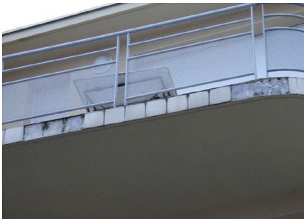
Décollements de revêtements en rives de nez de balcon (Crédit photo : Eurisk)
