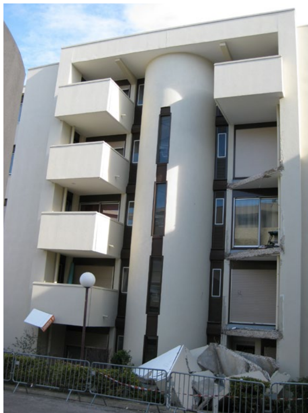
Effondrement d'un balcon (Crédit photo : AQC)
