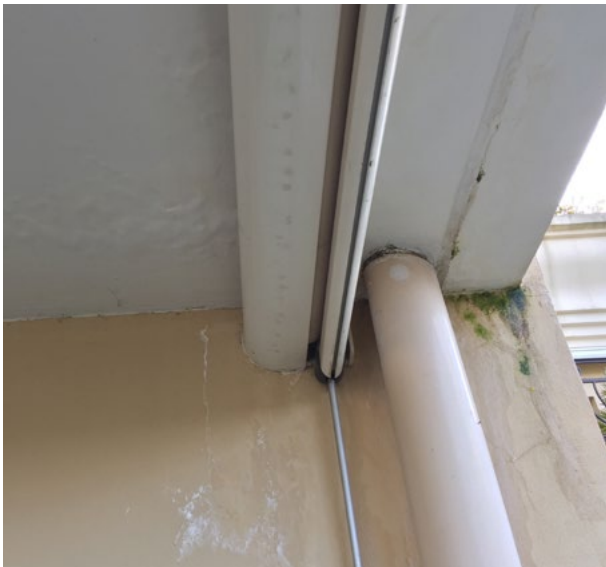
Infiltrations en sous-face de balcon par fissuration en cueillie latérale (Crédit photo : Socabat)
