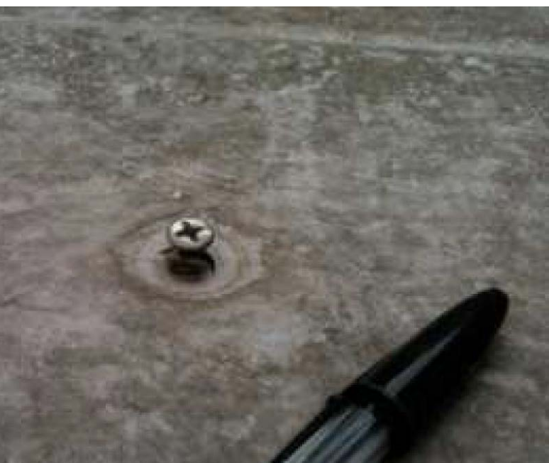
Poinçonnement de tête de fixation mécanique de revêtement d'étanchéité. (source : Eurisk)
