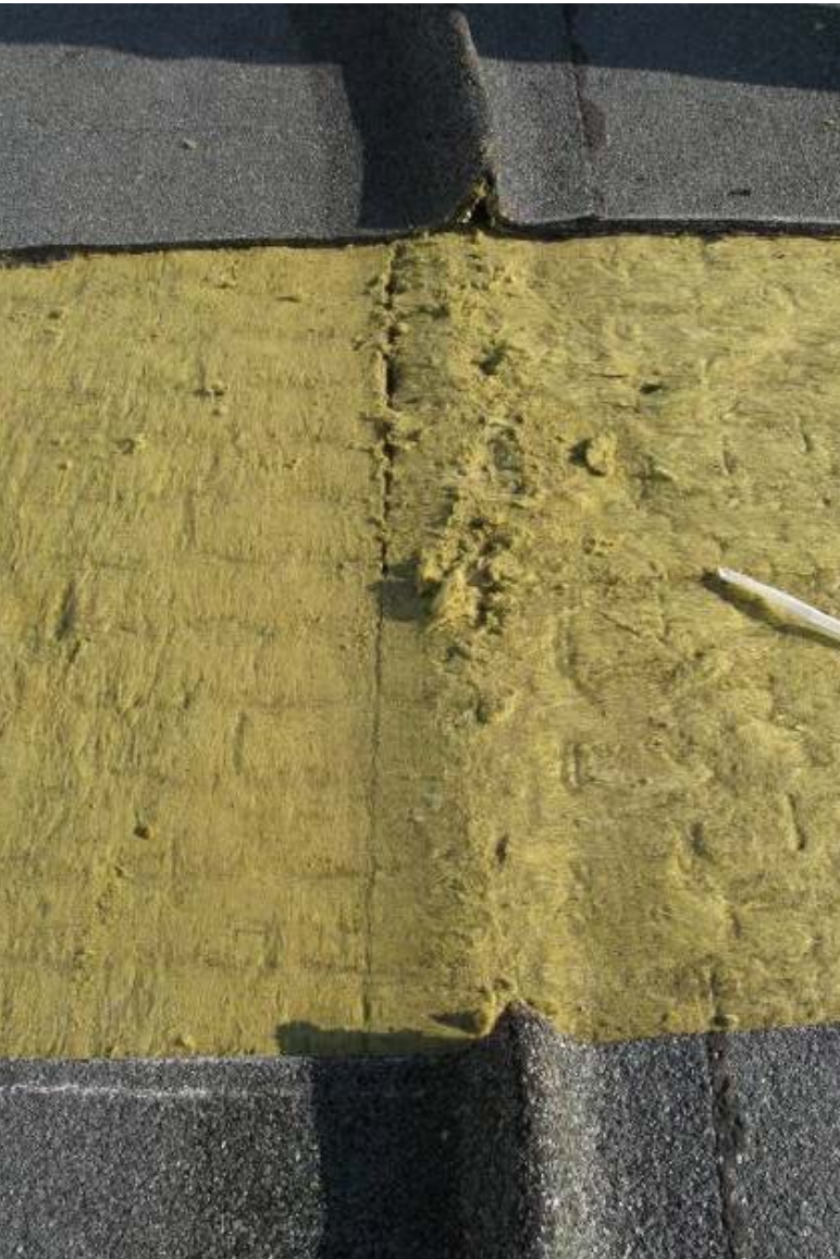
Déformation par compression au droit d'un joint entre panneaux isolants suite à leur délamination dans l'épaisseur. (source : Saretec)
