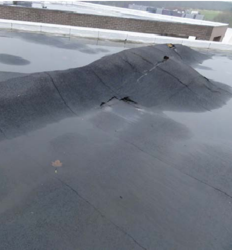
Soulèvement de panneaux isolants générant des déformations du revêtement d'étanchéité. (source : Saretec)
