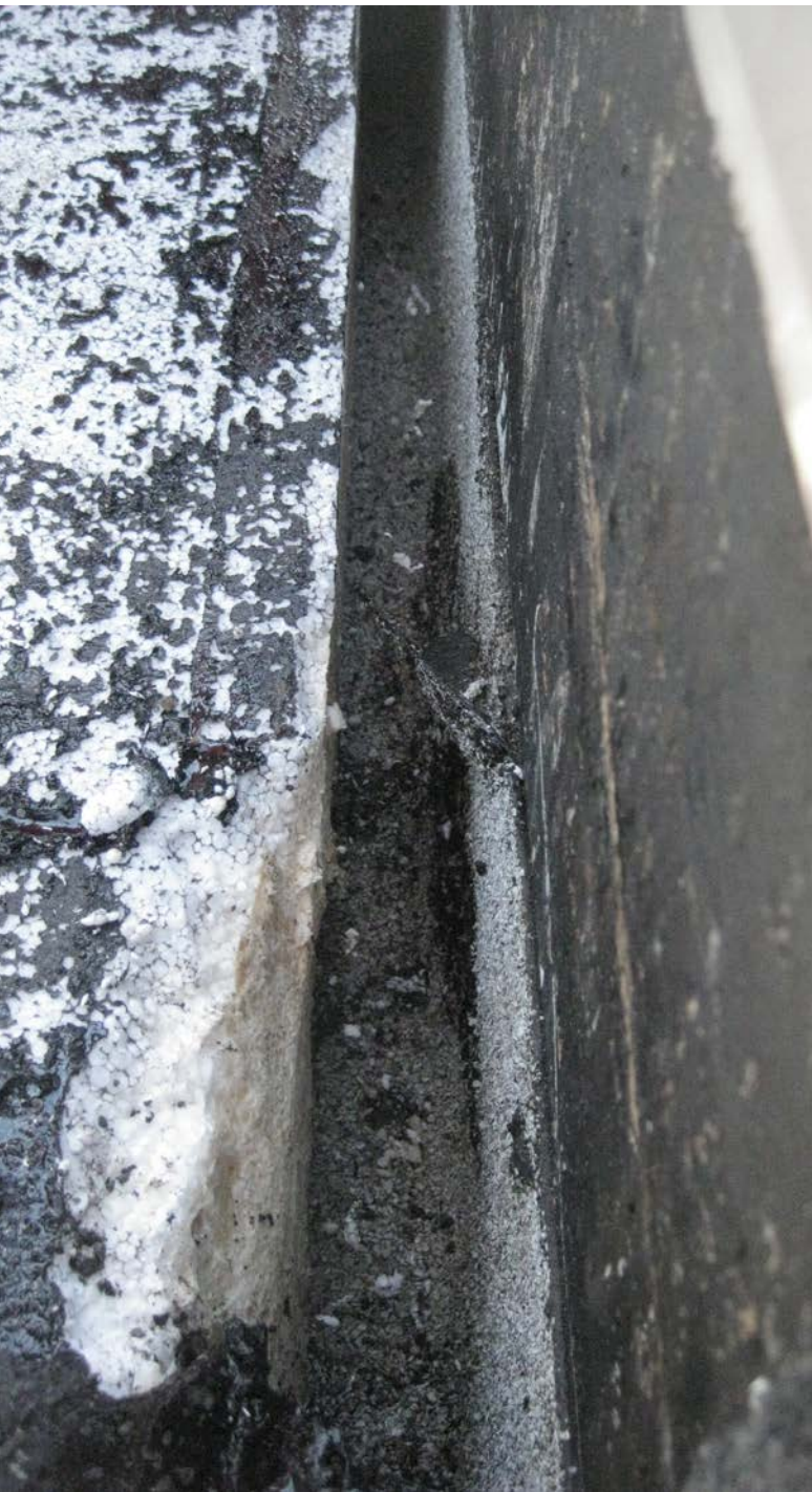
Rétraction cumulée de panneaux isolants en polystyrène en pied de relevé d'étanchéité. (source : Eurisk)
