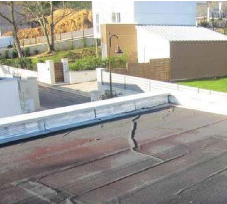
Plissement de membrane lié à la rétraction des panneaux isolants en polyisocyanurate supports. (source : Saretec)
