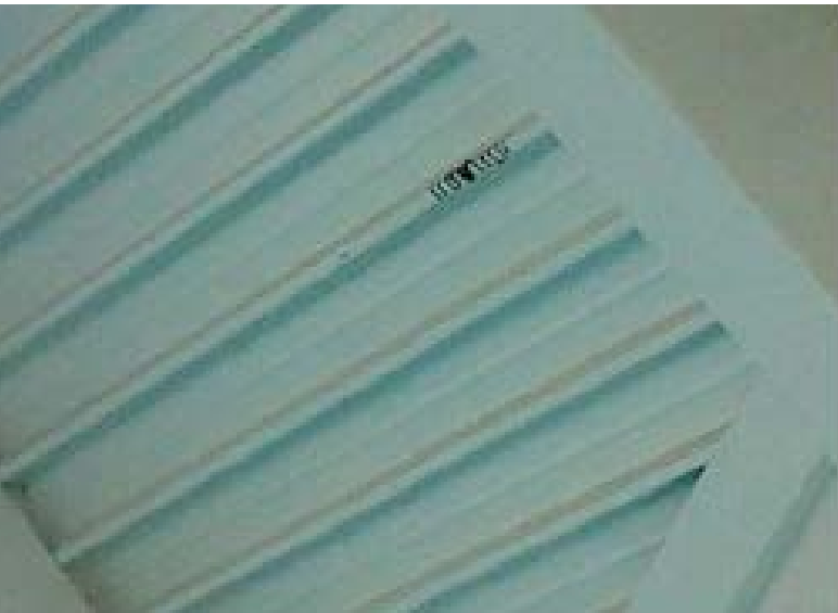
Coulure du bitume sous tôles d'acier nervurées liée à son ramollissement par fluage. (source : Eurisk)
