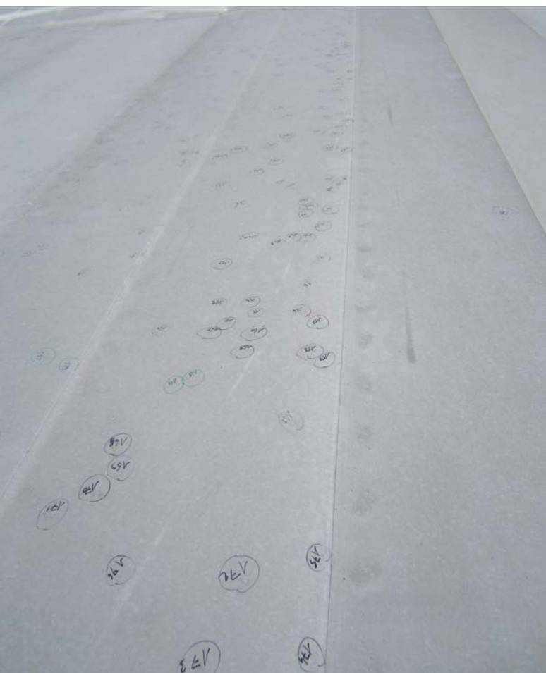
Impact de grêle sur membrane d'étanchéité en PVC (source : Eurisk)
