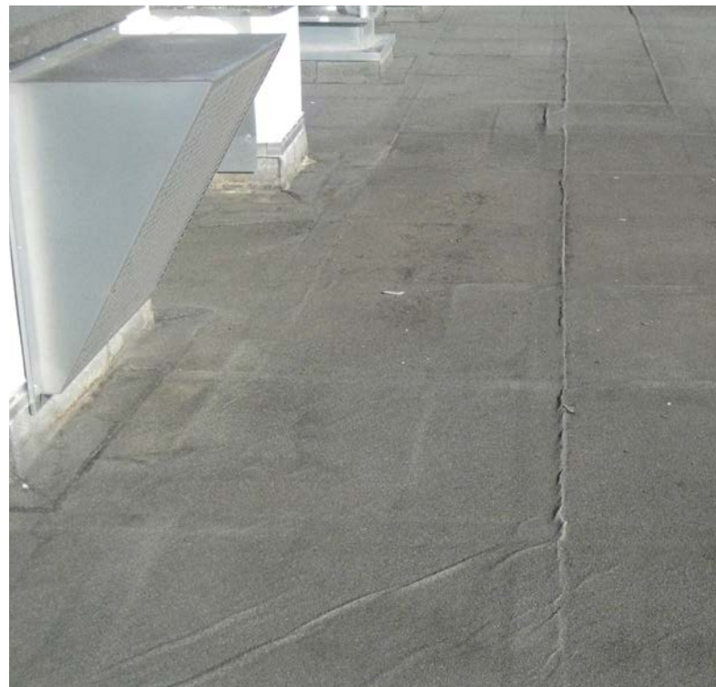
Plissement de membrane lié à la rétraction des panneaux isolants en polystyrène supports. (source : Eurisk)
