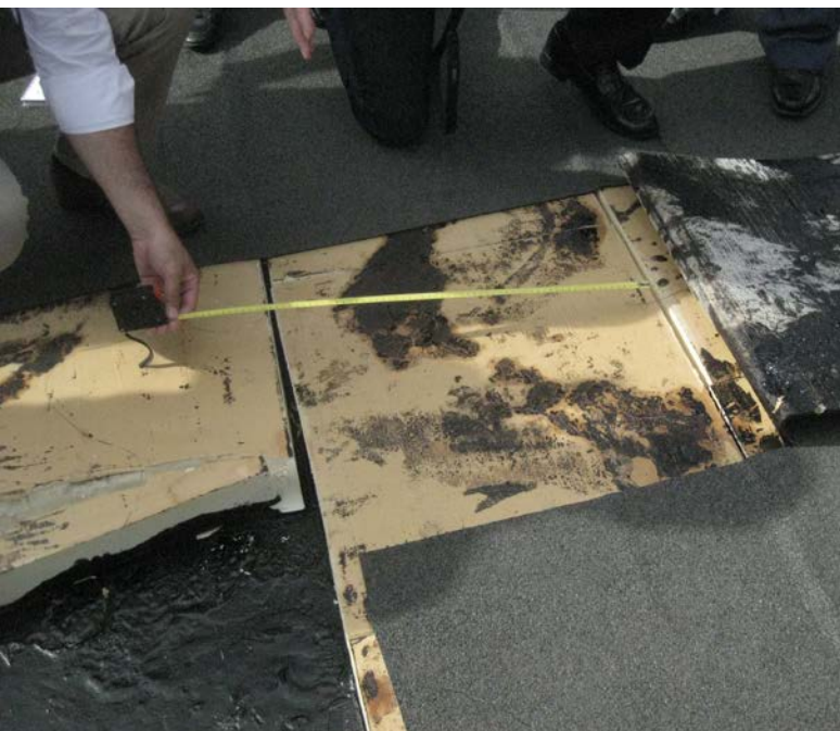
Rétraction de panneaux isolants en polyuréthane. (source : Eurisk)
