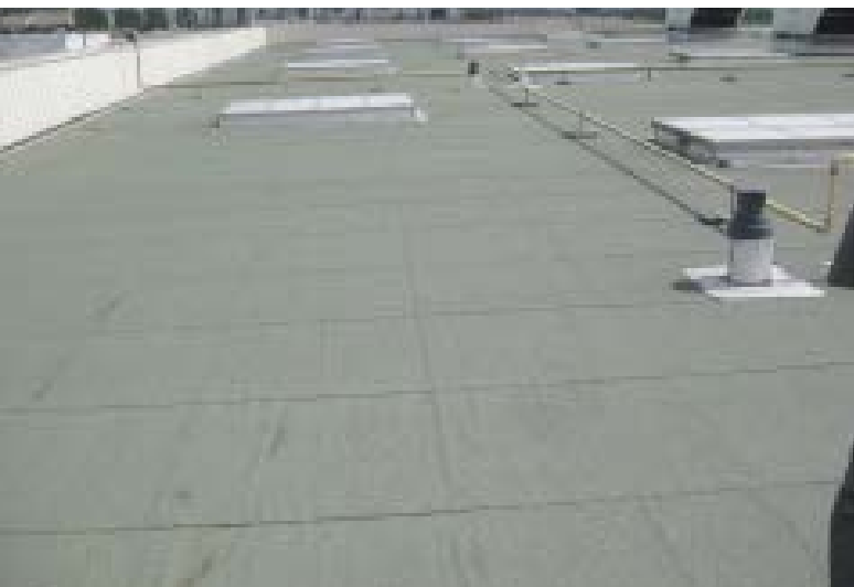
Pathologie sur membrane bitumineuse d'origine spécifique (source : Eurisk)
