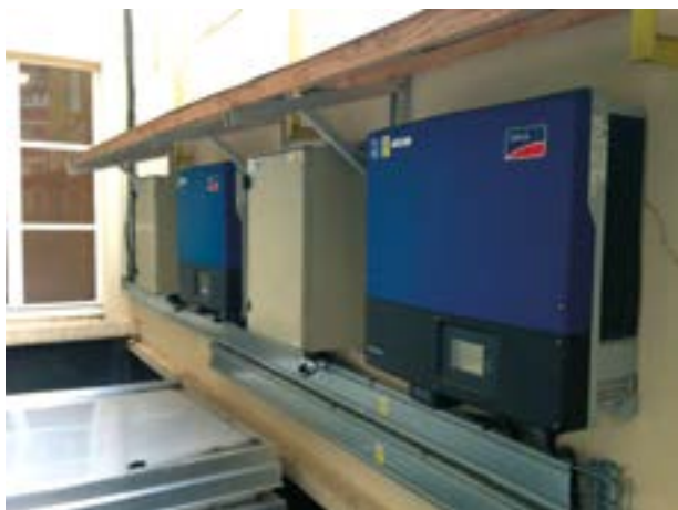
Onduleurs protégés des intempéries par une casquette – Photo SIPPEREC
