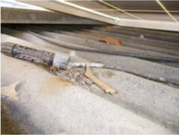
Accumulation de salissures retenant l'eau autour de connectiques. Photo EMASOLAR
