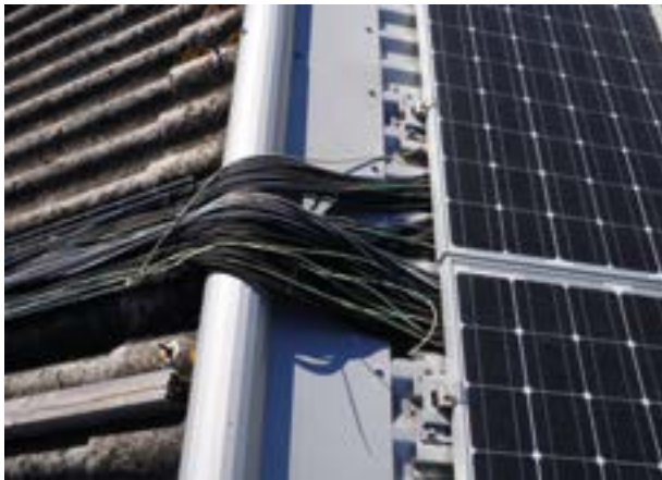
Absence de chemin de câbles - Photo : Antoine Farcot - AUTAN SOLAIRE
