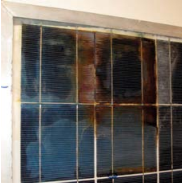
Module PV bi-verre délaminé et corrodé. Photo IEA PVPS T13
