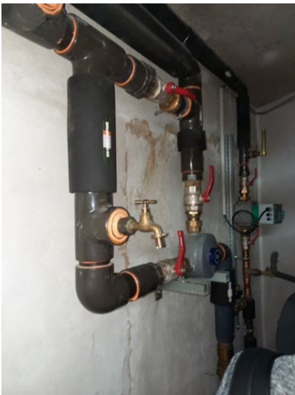
09. Canalisations en HTA partiellement calorifugées.
