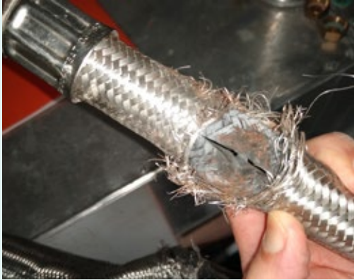
20. Éclatement d'un flexible inox résultant d'un défaut de montage. (Crédit photo : Eurisk)
