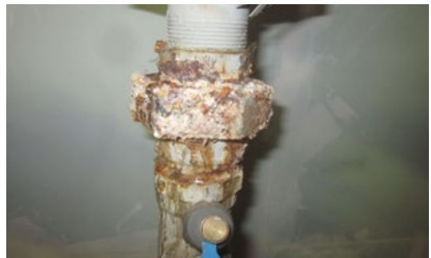
18. Raccord union corrodé du fait d'une mixité métallique ou d'une mauvaise qualité physico-chimique de l'eau. (Crédit photo : Eurisk)
