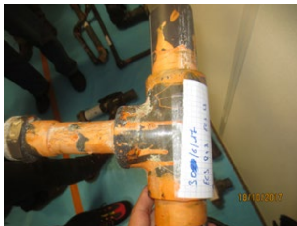
14. Fissuration d'une canalisation en HTA résultant d'un encollage excessif (Crédit photo : Eurisk)
