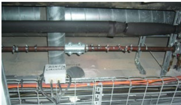
03. Nappe horizontale d'un réseau en tubes en cuivre affectée par une corrosion-érosion généralisée. (Crédit photo : Eurisk)
