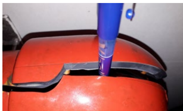
15. Rupture d'un coude en PVC pression résultant d'un coup de bélier. (Crédit photo : Eurisk)
