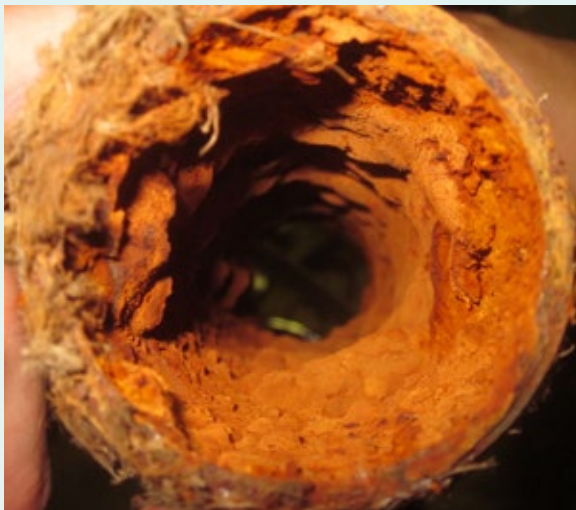
17. Corrosion de l'acier galvanisé. (Crédit photo : Eurisk)
