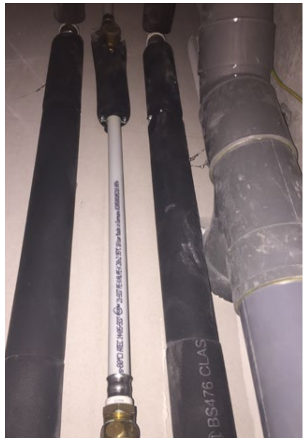
08. Canalisation en multicouche bouchonnée présentant un bras mort. (Crédit photo : Eurisk)
