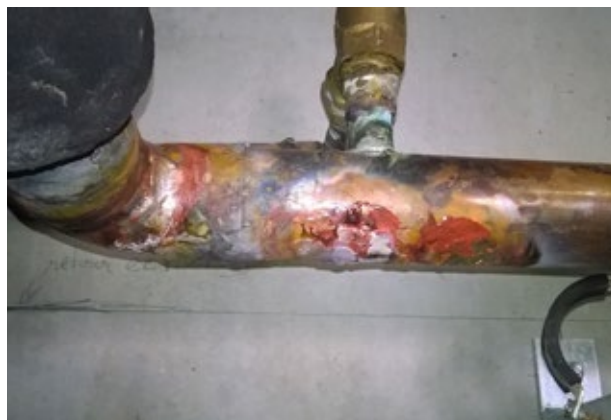
04. Canalisation d'eau chaude sanitaire affectée par des percements à répétition. (Crédit photo : Eurisk)
