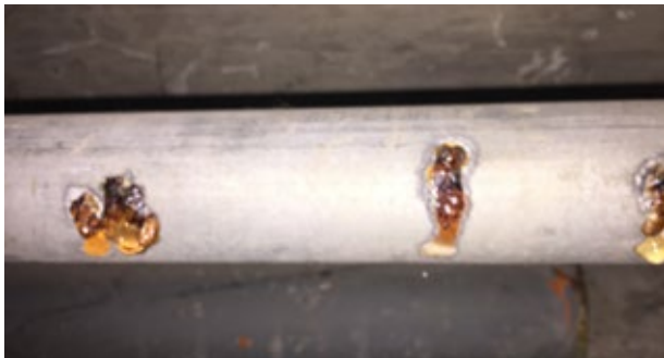
16. Canalisation en acier galvanisé fortement corrodée. (Crédit photo : Eurisk)
