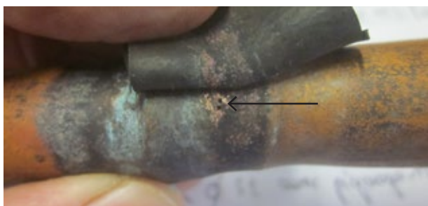
01. Percements d'un tube en cuivre sur la partie chauffée. (Crédit photo : Eurisk)
