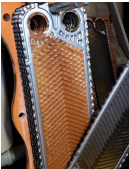
21. Encrassement important des plaques de l'échangeur. Cet encrassement génère un échange thermique insuffisant et une température d'ECS trop basse. (Crédit photo : Eurisk)
