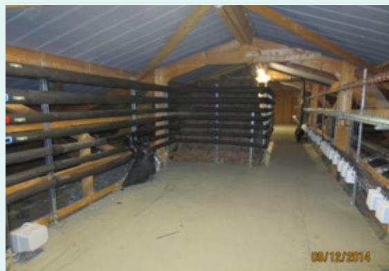
10. Réseau d'eau froide placé dans les combles non isolés.
