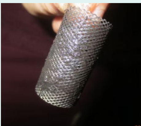
Filtre à tamis sur piquage d'un appartement
