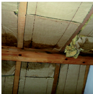
Exemple de condensation au travers de la paroi (photos prises après démontage des lambris). © 2015-AQC - Mathieu CORTAL (absence de pare-vapeur intérieur)
