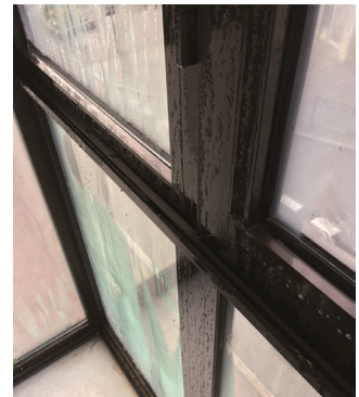
Exemple de condensation au niveau d'une menuiserie © 2017-AQC - Erwan BIDAN
