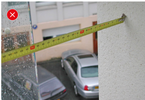
1. Vide excessif entre garde-corps et maçonnerie proche.
