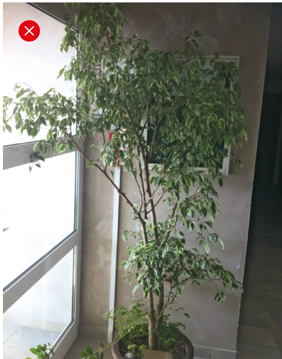
2. Tableau masqué par une plante, les plans et consignes doivent être visibles.
