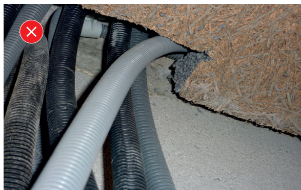
1. Dégradation du doublage
