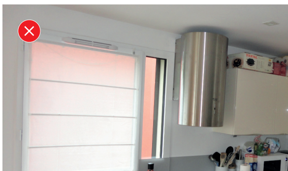
1. Entrées d'air dans une pièce de service.
