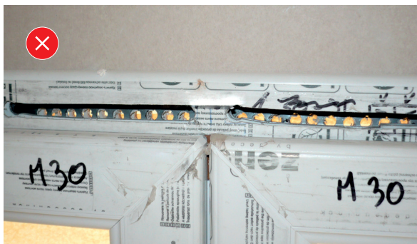
2. Entrées d'air non calibrées
