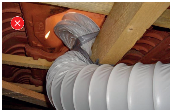
6. Étranglement du conduit.
