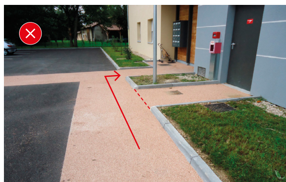
4. Rupture du guide (bordure trottoir) pour déficient visuel.
