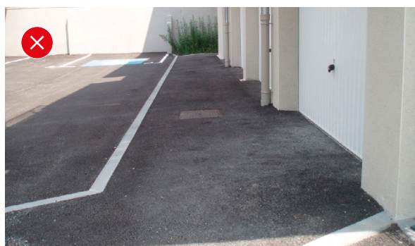
5. Devers de plus de 2 % sur cheminement.
