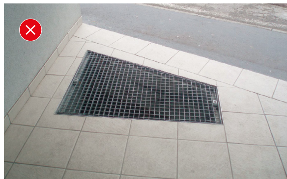
3. Grille avec maillage supérieur à 2 cm barrant le cheminement extérieur.
