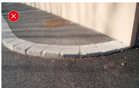
2. Ressaut de plus de 2 cm sur cheminement au droit de la jonction avec la voirie.
