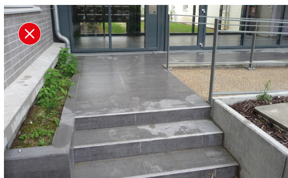
7. Traitement incomplet de marches isolées sur un cheminement (absence d'éveil de vigilance, contre-marches d'extrémité non contrastées).
