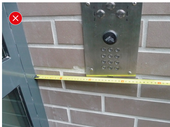
1. Commande de portier à moins de 0,40 m de l'angle formé avec la baie vitrée.
