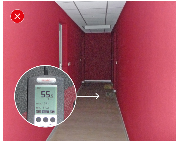
2. Éclairage insuffisant dans la circulation horizontale (55,5 au lieu de 100 lux) au niveau du paillason d'une porte palière.
