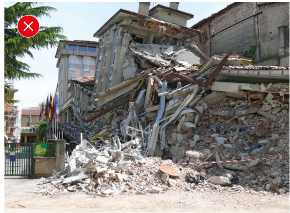
2. Effondrement d'un bâtiment dû à la présence d'un rez-de-chaussée souple (espace en poteaux-poutres pour permettre à des véhicules de se garer sous la structure).
