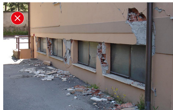
3. Cisaillement de l'ensemble des poteaux courts du rez-de-chaussée semi-enterré.
