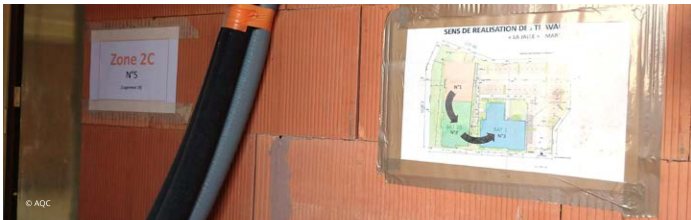
Exemple de zonage affiché sur le chantier pour un repérage facile et partagé.
