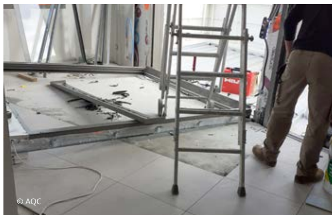
Poste de travail sur chantier non organisé
