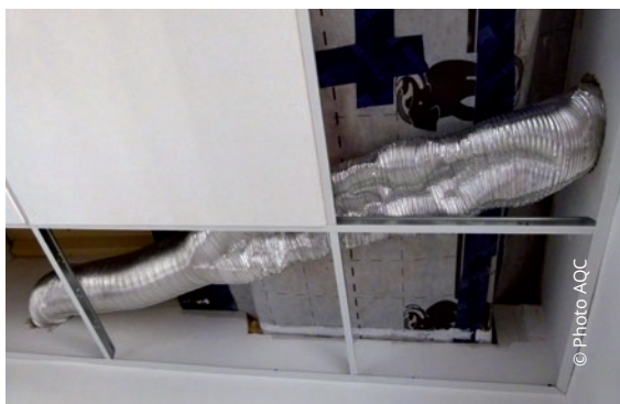
❌ Gaine souple de ventilation écrasée
