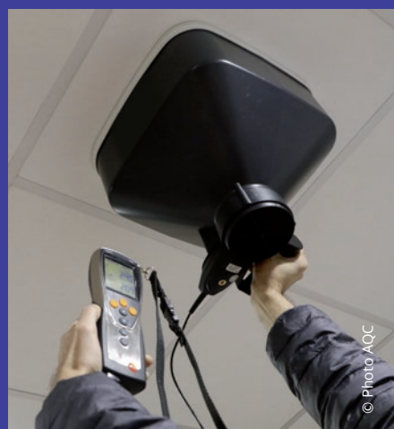
✓ Mesure de débit aux bouches d'extraction.
