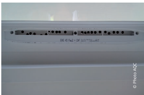
❌ Absence de mortaise pour l'entrée d'air
