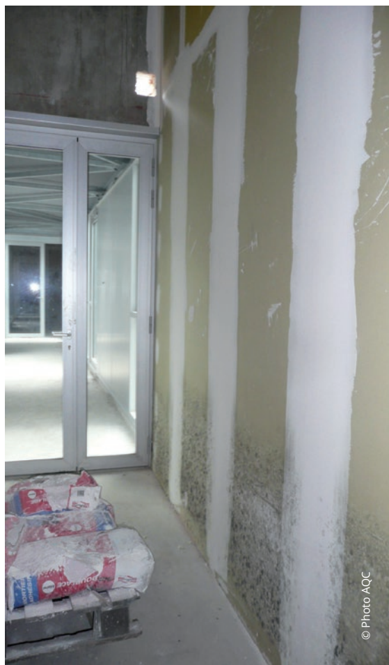
Développement de moisissures sur plaques de plâtre en phase chantier
