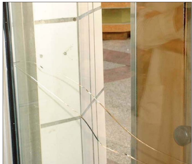
Gradient thermique de moyenne amplitude. Fissure bifilaire
