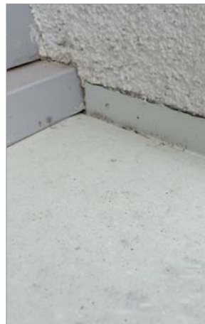
Désordre fréquent sur ITE. Défaut de calfeutrement de la bavette à la jonction avec l'ITE. Parfois les bavettes ne montent aucune remontée sur les côtés.
