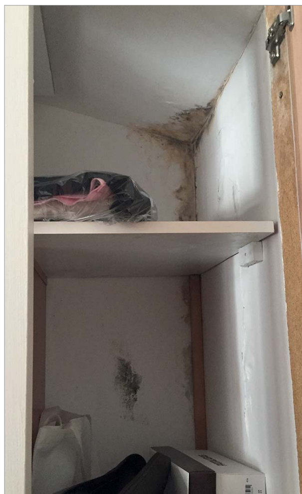
Apparition de moisissures sur parements internes d'une habitation suite à mise en œuvre d'une ITE.
