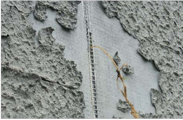
Fissuration du système : Mauvais positionnement de l'armature dans la couche de base (marouflage non conforme) et couche unique épaisse de sous enduit sans marouflage de la trame, pratiquement collée sur la surface avant la finition, qui elle, se décolle après fissuration.
