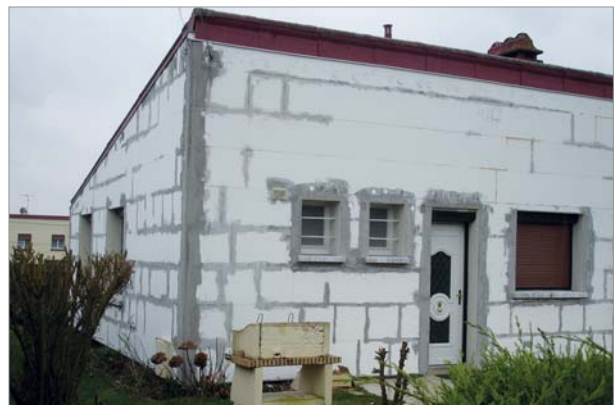
Comblement de joints entre panneaux créant des points durs et empêchant la bonne réponse du complexe ITE aux sollicitations mécaniques ou thermiques.
