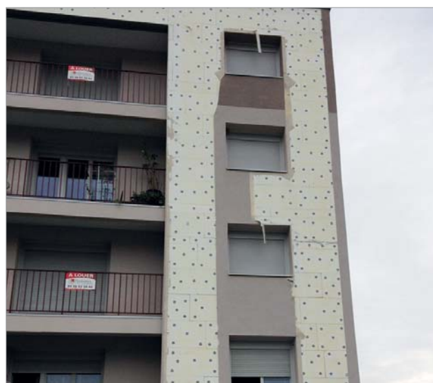
Chute de l'ITE par défaut d'adhérence du sous enduit sur un PSE exposé pendant plusieurs semaines au soleil (PSE jauni, temps de recouvrement non respecté).
