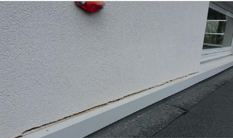
Désolidarisation de l'ITE sur la couverture du bandeau filant (risque d'infiltration).
