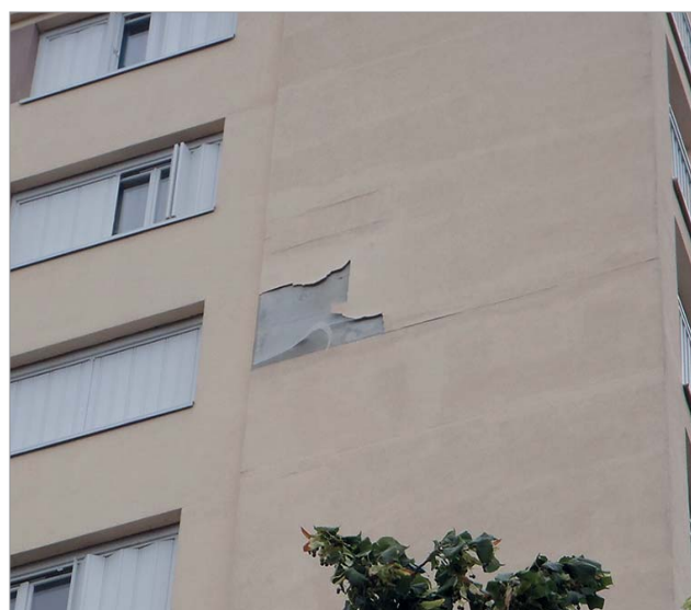
Infiltrations, cloquages et décollements par plaques de la finition dus à une préparation de support négligée aux reprises de bétonnage.
