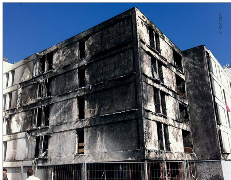
Incendie sur façade ITE avec isolants combustibles
