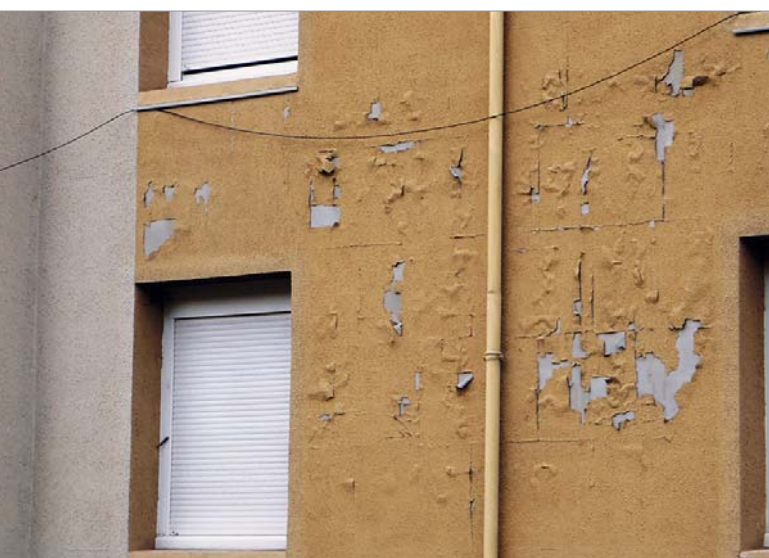
Fissuration, infiltration d'eau, écaillage et décollement de la finition dus à un enduit de base trop raide et de faible épaisseur (non-respect des consommations). Teinte foncée en facteur aggravant.
