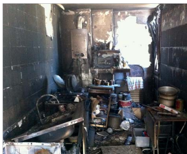
Départ de feu dans la cuisine qui s'est propagé à la façade
