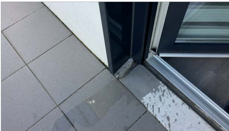
Contrepente sur balcon vers l'ITE, pas d'espace entre ITE et sol du balcon, tranche d'ITE non traitée en tableau et infiltrations d'eau par le seuil de baie.
