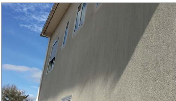
Salissures et cryptogames en façade.
