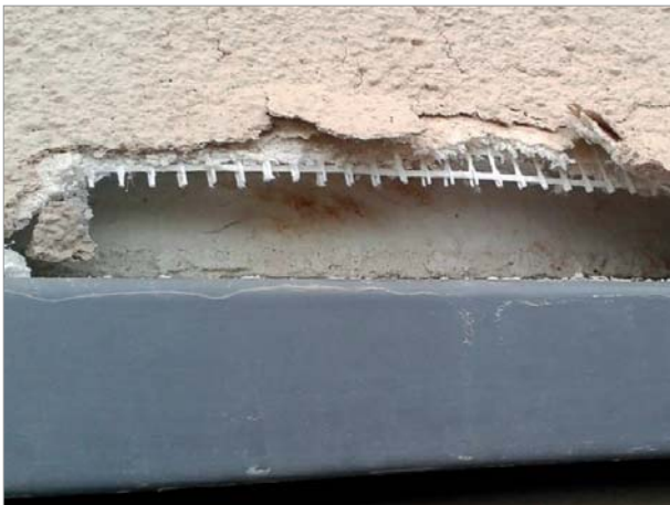
Dégradation totale du complexe ITE et lessivage de l'enduit de base.
