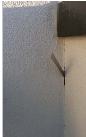
Jonction d'angle avec trame interrompue : zone de discontinuité et de fragilité.
