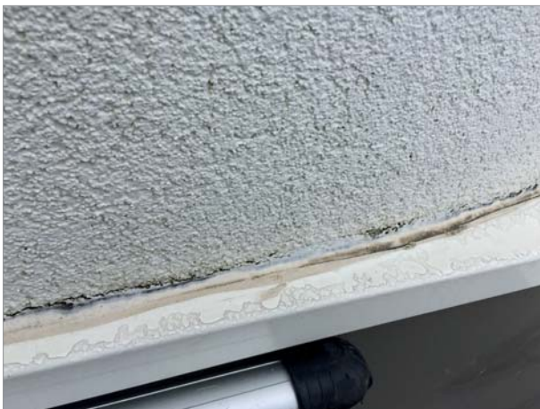
Couvertines sur bandeau filant d'étage et une ITE venant y prendre appui. Fissuration longitudinale et décollement de la finition d'ITE. L'explication du désordre réside dans l'absence d'un profilé de départ formant larmier sur la couvertine filante.
