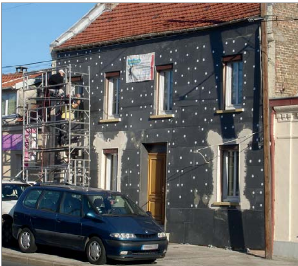
PSE gris non protégé par bâchage anti UV, absence de soubassement, nombre de fixations aléatoires, joints PSE filants.
