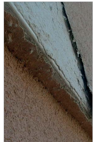
Défaut de protection en tête au niveau de la couverture. Infiltration en arrière (derrière l'isolant) du complexe et entre l'enduit et la finition. Lessivage prononcé de l'enduit. Décollement / pelage de la finition.
