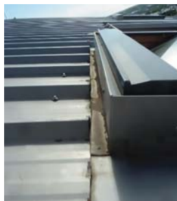
Exemple de défaut de raccordement de la jupe d'une fenêtre de toit (île de La Réunion).
