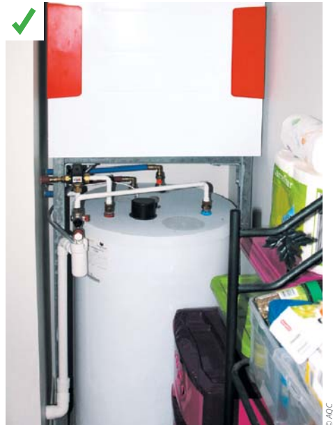
Dans un bâtiment d'habitation collective passif, ce ballon individuel de 150 L est situé très proche du point de puisage.
