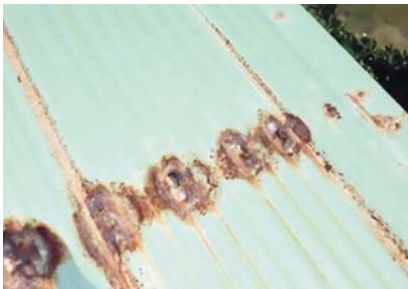
Exemple de corrosion par couple galvanique entre tirefonds inox et tôles d'acier laqué (Antilles).
