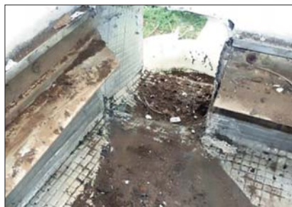
Toiture-terrasse : point ponctuel d'infiltration au niveau du raccordement du complexe d'étanchéité de la partie courante avec la traversée du voile au droit de la boîte à eau métallique (île de La Réunion).
