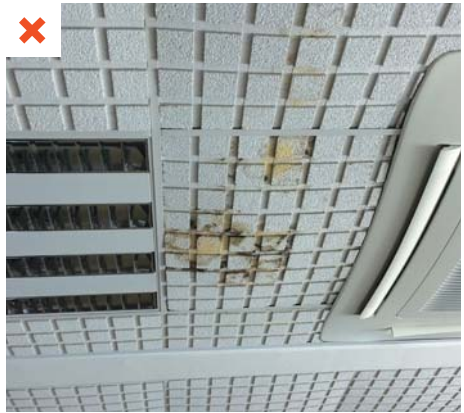
Développement de moisissures sur les faux plafonds.
