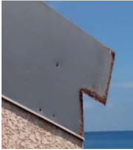
La découpe des tôles de couverture ne fait pas toujours l'objet d'une reprise de laquage (île de La Réunion).
