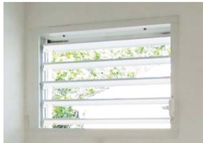
Exemple de jalousie avec trace d'infiltration au coin inférieur gauche (Antilles).
