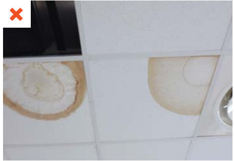
Traces de condensation dues à l'absence d'isolation des réseaux de froid.
