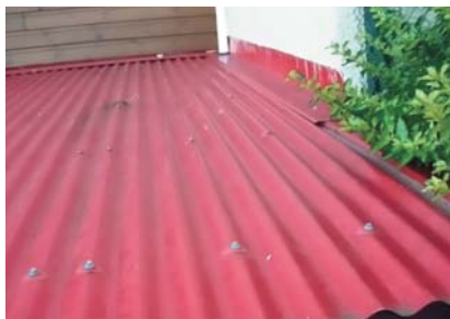
Serrage excessif de rondelles d'étanchéité (île de La Réunion).
