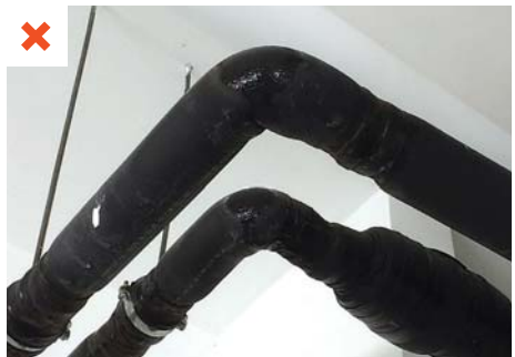
Réseau d'eau glacée présentant des traces de condensation.
