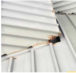
L'architecture de certaines couvertures, aux formes parfois complexes, multiplie le nombre de points singuliers à traiter et favorise donc l'apparition de sinistres en cas de défaut de mise en œuvre (île de La Réunion).
