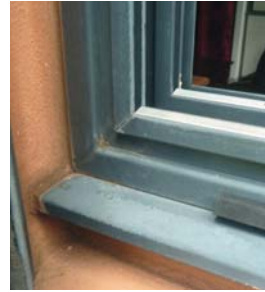
Les découpes d'onglets ne sont pas parfaitement jointives et les cordons d'étanchéité sont inexistantes (île de La Réunion).
