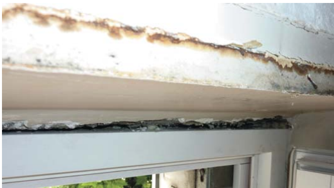
Irrégularité du support qui ne permet pas une pose convenable de la mousse imprégnée pré-comprimée.
