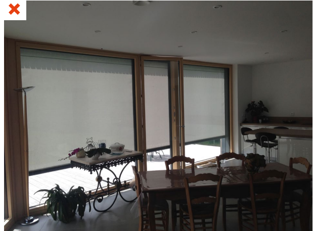
Dans cette maison individuelle, les stores extérieurs, utilisés comme protections solaires sur la façade Sud, se baissent de manière inappropriée malgré les tentatives d'ajustement de l'utilisateur. ©AQC
