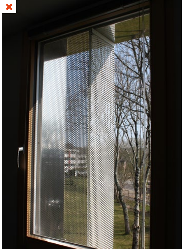
Encadrement extérieur en aluminium provoquant de l'éblouissement Façade EST. ©AQC
