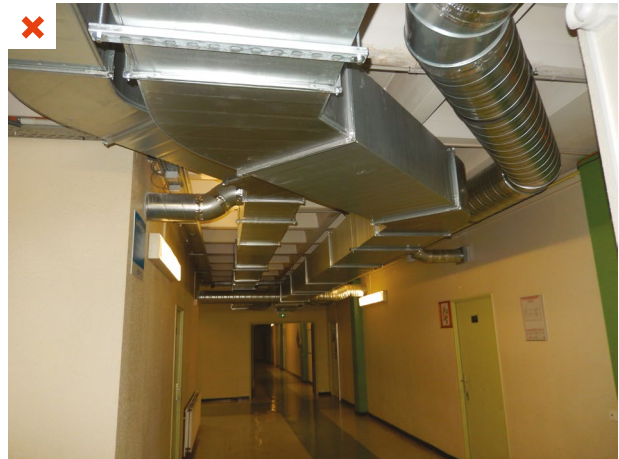
La luminosité dans les espaces de circulation est insuffisante. ©AQC
