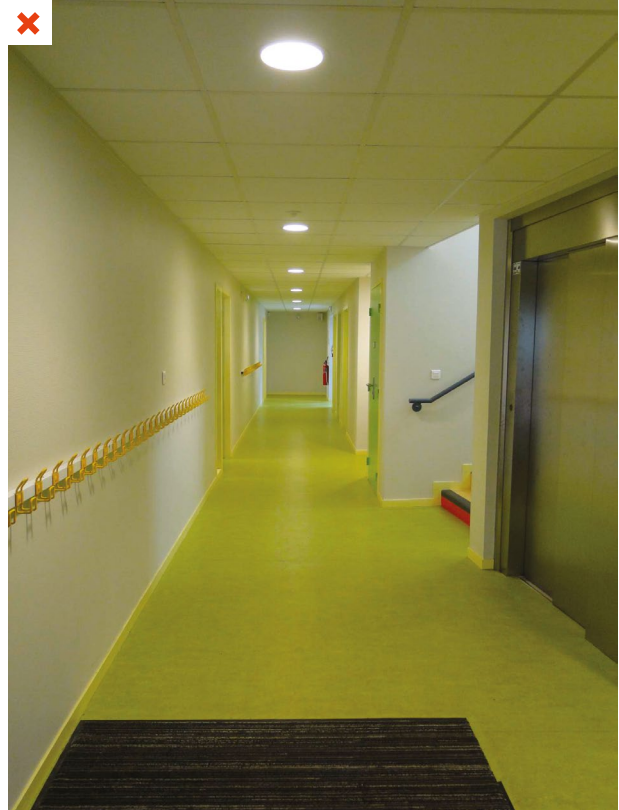
L'éclairage de la cage d'escalier (à droite après l'ascenseur) est à extinction manuelle, alors que les autres espaces de circulation (couloirs) sont à extinction automatique. Les luminaires de la cage d'escalier restent très souvent allumés, les usagers pensent que l'extinction est automatique comme pour l'espace de circulation. ©AQC
