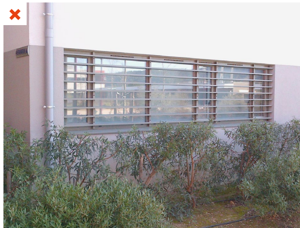
Brise-soleil fixes ne permettant pas le nettoyage des vitres. ©AQC
