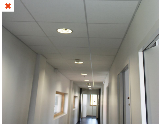
L'éclairage électrique de l'espace de circulation est constamment allumé bien qu'un interrupteur crépusculaire soit présent. ©AQC
