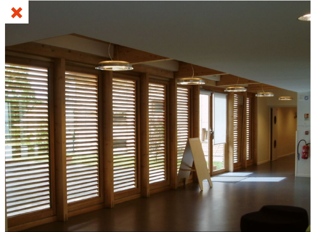
Surdimensionnement des brise-soleil – Hall d'entrée. ©AQC
