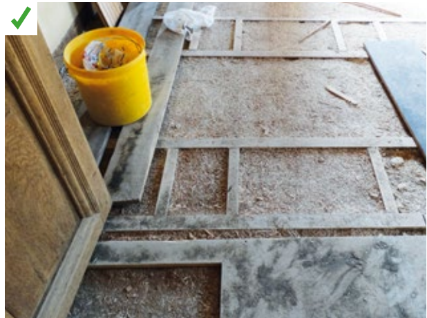
L'ensemble du remplissage existant (gravas, sable, plâtre) entre solives a été cureté. Un isolant à base de fibres végétales a été mis en œuvre en remplacement afin de répondre aux besoins thermiques et acoustiques. ©AQC
