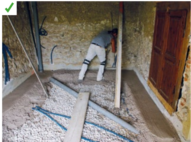
Traitement thermique du soubassement du mur par l'intérieur au moyen d'une dalle en béton de chaux-pouzzolane. Celle-ci repose sur un hérisson sur drain ventilé. ©AQC
