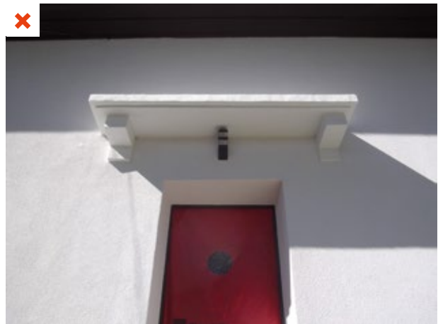
✘ Lors de l'isolation par l'extérieur, l'auvent en béton a été conservé. Un pont thermique a ainsi été créé. ©AQC
