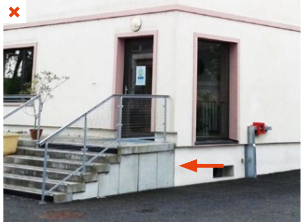
Lors de l'isolation par l'extérieur de cette bâtisse ancienne, le soubassement et les nez de dalles n'ont pas été traités. Il en résulte des ponts thermiques. ©AQC
