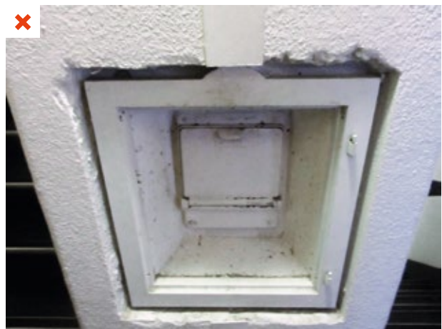
Ancienne trappe de vide-ordures conservée en l'état sans amélioration de l'étanchéité à l'air. ©AQC
