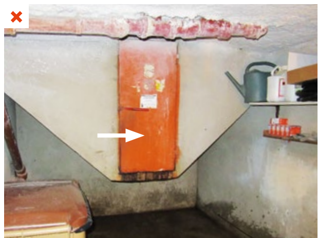
L'ancien système de vide-ordures donnant sur un volume non chauffé a été conservé sans travaux d'isolation ni d'étanchéité à l'air. ©AQC
