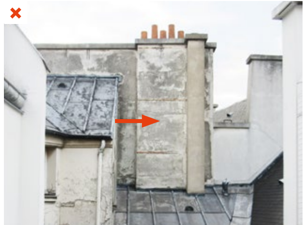
Conduits d'anciennes cheminées, ni isolés, ni étanches à l'air. ©AQC
