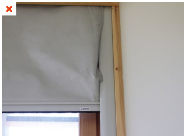
L'automatisation des stores déclenche très régulièrement des cycles d'ouverture/fermeture. Certains stores finissent par s'abîmer. ©AQC
