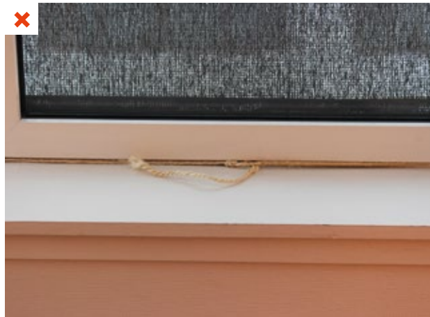
L'automatisation des stores déclenche très régulièrement des cycles d'ouverture/fermeture. Une ficelle a été ajoutée par les usagers afin de maintenir le store fermé. ©AQC
