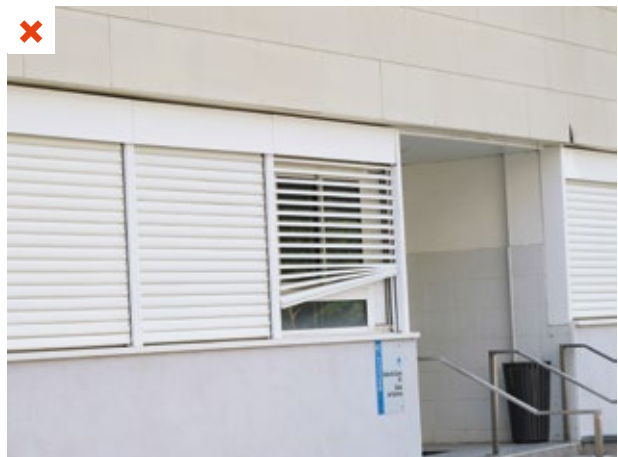
L'automatisation des stores déclenche très régulièrement des cycles d'ouverture/fermeture. Certains stores finissent par s'abîmer. ©AQC
