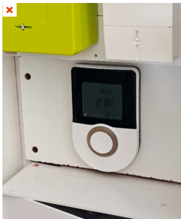
Dans ce logement, l'indicateur de consommation d'énergie connecté ne fonctionne pas. Le locataire n'a pas accès à ses consommations par usage. ©AQC
