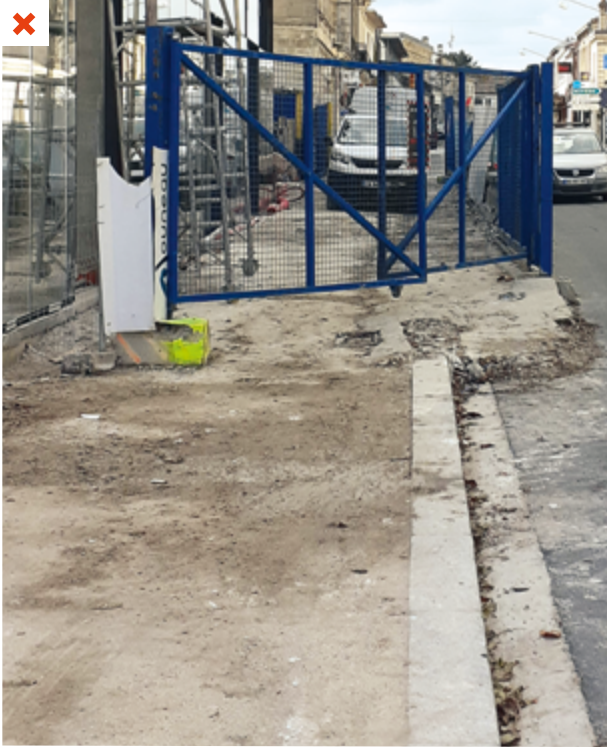
La zone de chantier empiète sur le trottoir. Aucune signalétique n'a été mise en place pour la sécurité du piéton. ©AQC
