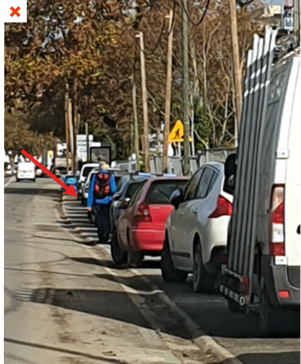
Les véhicules des intervenants du chantier stationnent sur le trottoir. Le piéton n'a pas d'autre choix que de marcher ponctuellement sur la route. ©AQC
