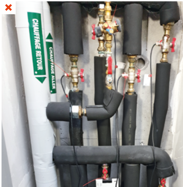
Le calorifugeage du réseau de chauffage est mal réalisé et insuffisant induisant des déperditions importantes de calories. La gaine technique est située dans une zone non chauffée. ©AQC
