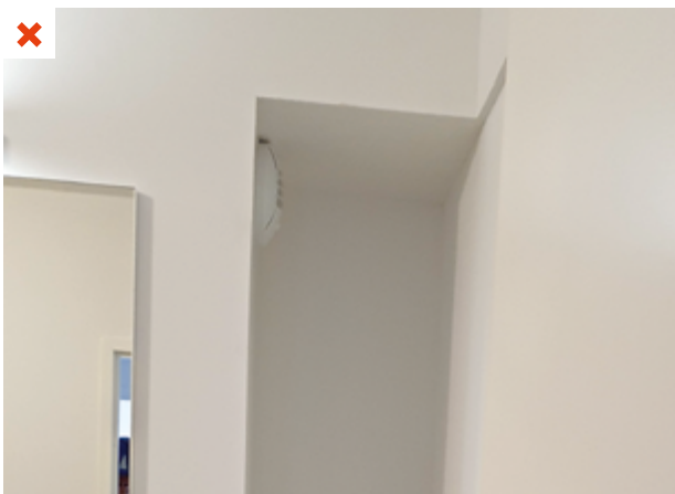
Les extractions d'air sont mal positionnées. L'une est placée trop près de la colonne de douche entraînant une mauvaise qualité d'usage. L'autre censée être l'extraction des toilettes situées derrière la cloison se retrouve positionnée dans la salle de bains. Les deux difficultés sont issues d'un manque de coordination des acteurs. ©AQC
