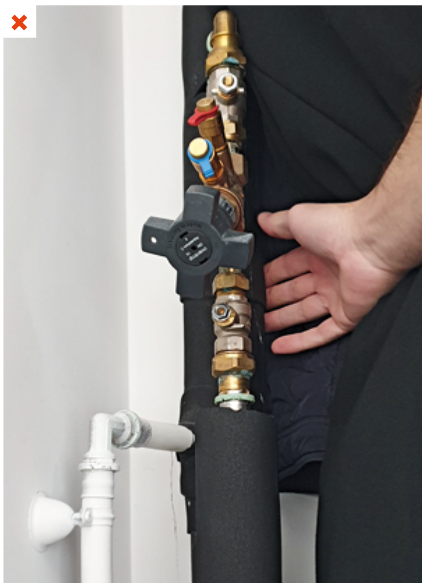
Les organes d'équilibrage du réseau d'eau chaude sont situés dans la penderie de l'entrée. L'occupant peut dérégler l'équilibrage hydraulique réalisé par l'installateur à la réception de l'installation. ©AQC
