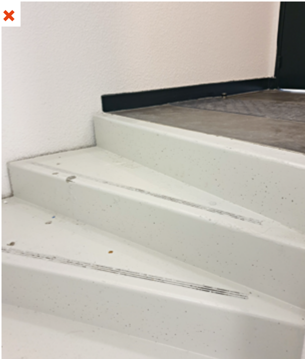
Une absence de nez de marche et une dernière contre-marche non contrastée rendent difficiles l'utilisation de cet escalier par les personnes malvoyantes. ©AQC
