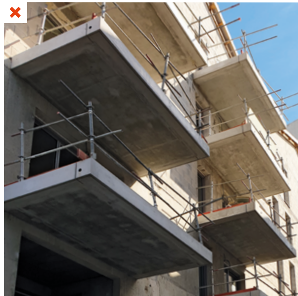
Non traités, les ponts thermiques à la jonction mur/balcons entraînent des déperditions linéiques importantes. ©AQC
