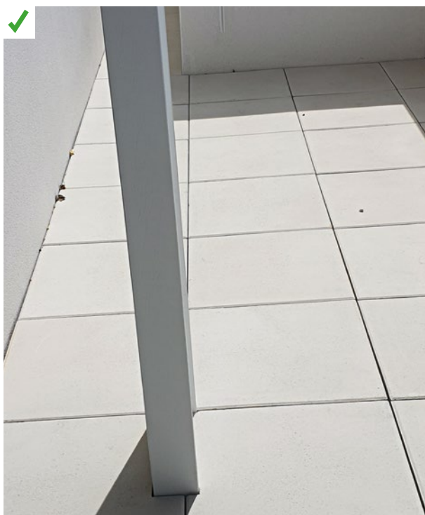
Un enduit extérieur et un carrelage de terrasse de couleur claire (coefficient d'absorption de 0.2) participent au confort d'été en réfléchissant le rayonnement solaire. ©AQC
