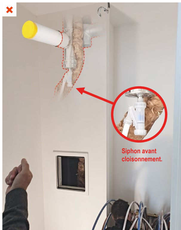
La trappe d'accès trop basse ne permet pas de réaliser l'entretien du siphon ©AQC
