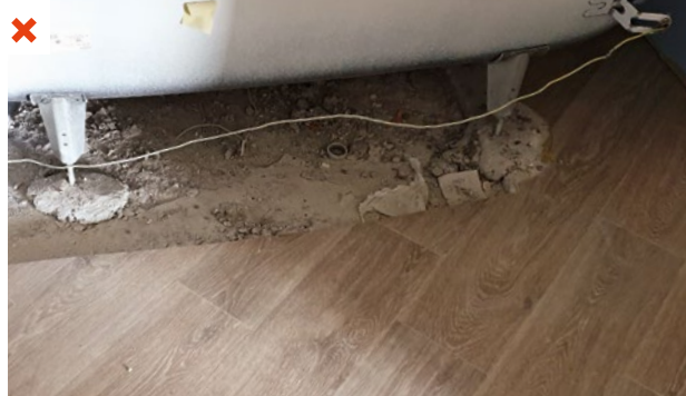
Les pieds de baignoire métalliques fixés au sol par un plot de mortier ne sont pas désolidarisés de la dalle. ©AQC
