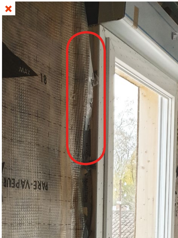
La jonction mur/menuiserie n'est pas assurée entraînant un défaut d'étanchéité à l'air. ©AQC
