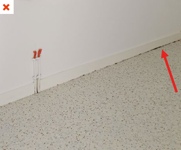
Des moisissures se développent en pied de cloison dans cette salle de bains d'un logement témoin dépourvue d'ouverture et de ventilation (phase chantier). ©AQC
