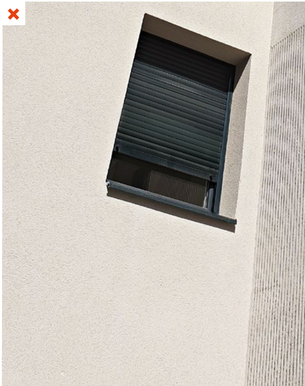
Le volet roulant installé en façade sud-ouest capte les rayonnements solaires et favorise la montée en température dans les logements. ©AQC
