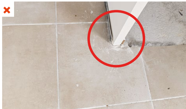
La remontée de la bande de rive est absente. L'isolation acoustique n'est pas assurée au niveau de l'extrémité de la cloison. ©AQC
