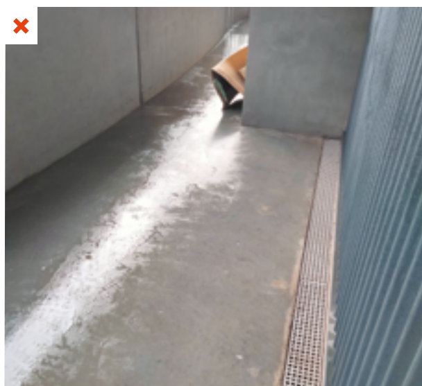
Les coursives en béton brut sont jugées inesthétiques par les usagers. ©AQC
