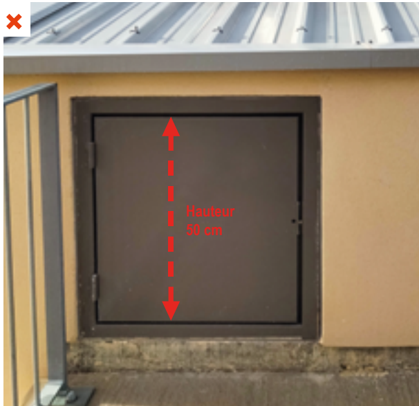
Passage trop étroit pour accéder au système de ventilation pour l'entretien et la maintenance. ©AQC
