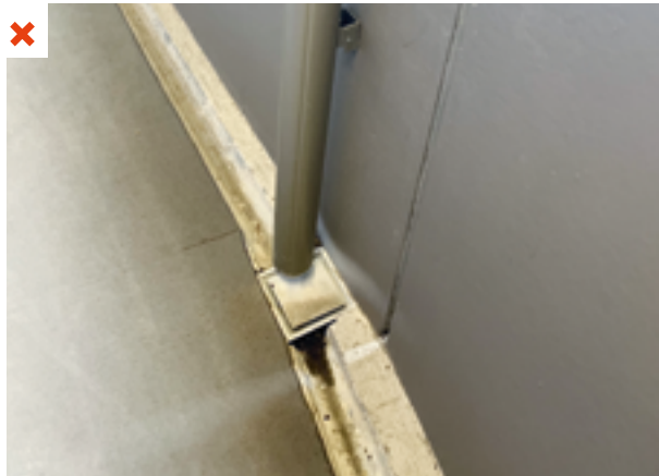
La descente d'EP est mal positionnée. L'eau arrive sur une plaque pleine et se répand sur toute la surface de la coursive ©AQC
