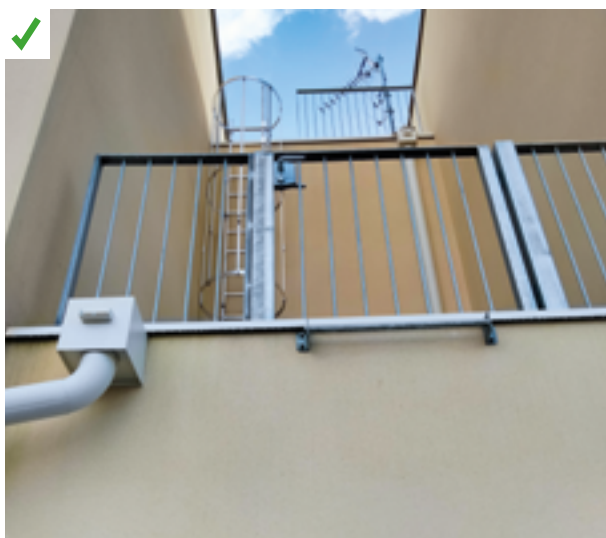
Accès sécurisé en toiture pour les opérations de maintenance ou d'entretien. ©AQC
