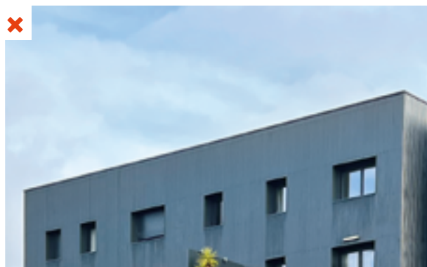
Revêtement de couleur noire et absence de protection solaire sur une façade exposée à l'ensoleillement. ©AQC
