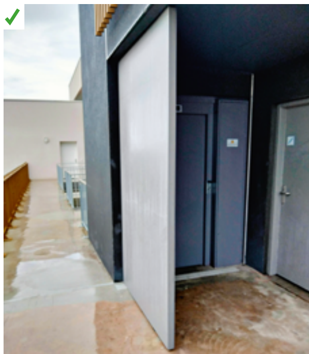
La paroi verticale, ajoutée pour protéger de la pluie, permet à l'ascenseur de rester constamment au sec. ©AQC
