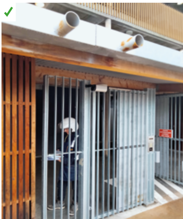
L'eau de la coursive se déverse à l'aplomb de la grille d'entrée des piétons ©AQC
