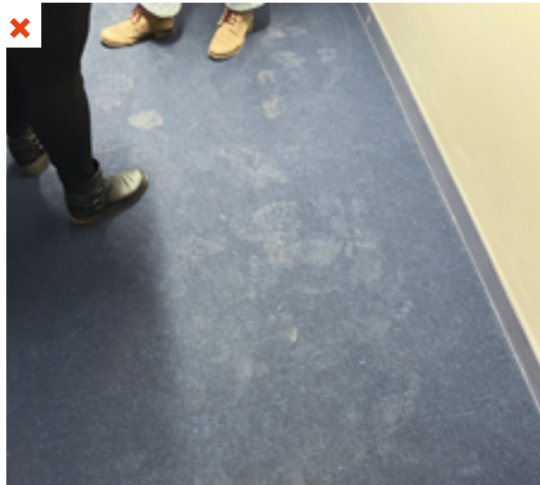
Moquette sombre dans les communs laissant des traces au moindre passage. ©AQC
