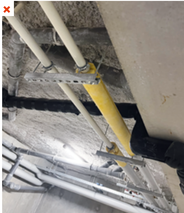
Le calorifugeage des canalisations d'eau chaude en zone froide n'a pas été remis en place après intervention. ©AQC
