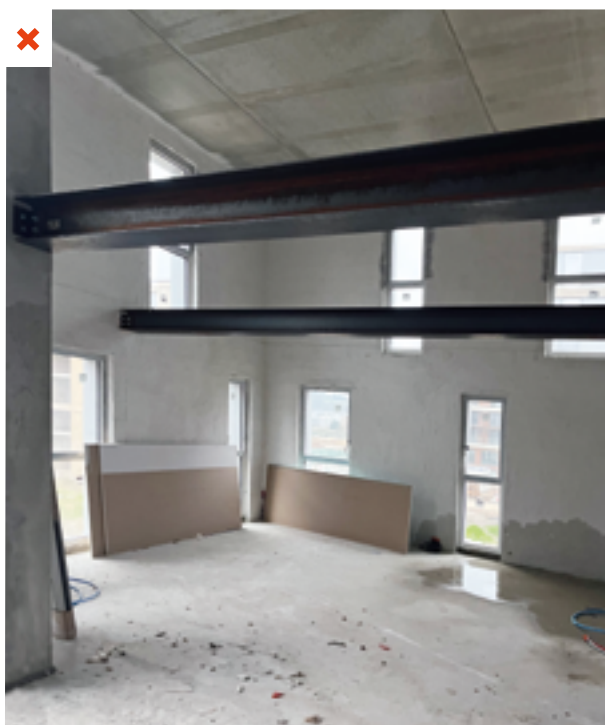
Logement livré en l'état en vue d'un agencement ultérieur. Si l'acquéreur est non-sachant, l'appartement risque de ne pas atteindre les performances et la conformité requises. ©AQC
