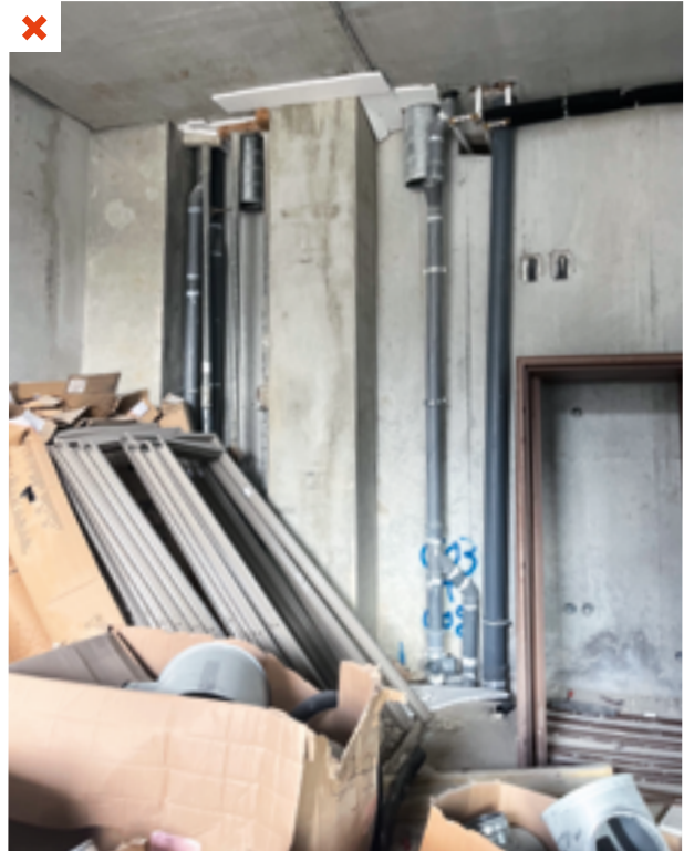
Zone de stockage improvisée. ©AQC
