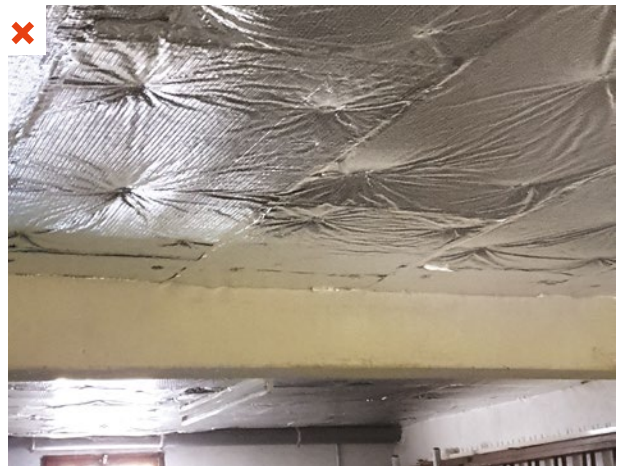
La poutre béton du garage n'est pas isolée car l'isolant ne peut pas être agrafé sur la poutre. ©AQC
