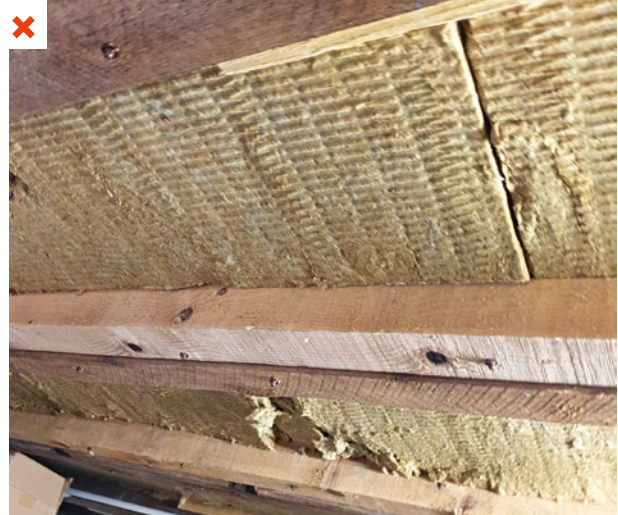
Une seule couche d'isolant est positionnée entre les solives entraînant des ponts thermiques. ©AQC
