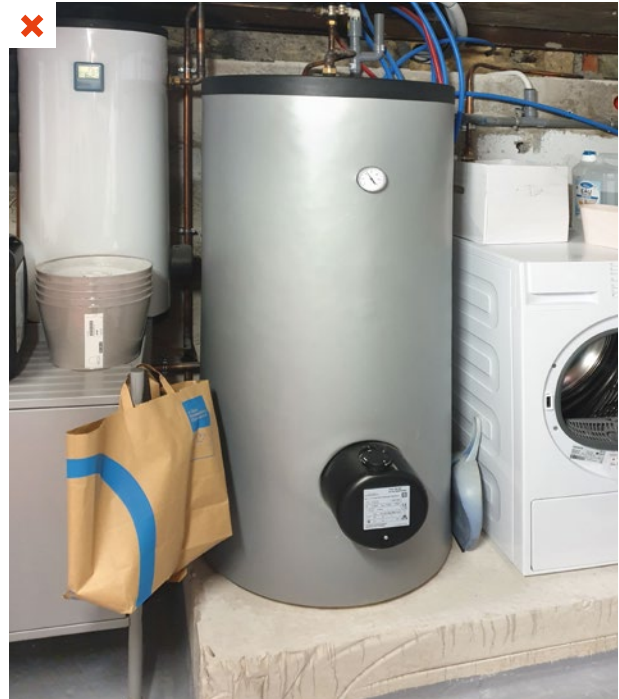
Les équipements de génie climatique initialement au rez-de-chaussée sont installés en sous-sol inondable. Celui-ci étant de surcroît mal ventilé, la détérioration des équipements est inéluctable. ©AQC ⚠
