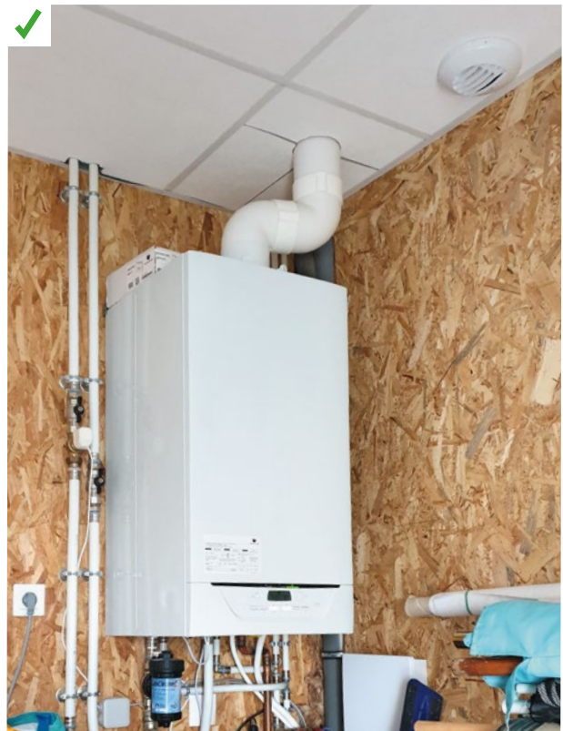
Les équipements techniques sont installés au rez-de-chaussée de l'habitation dans un local technique correctement ventilé. ©AQC ⚠
