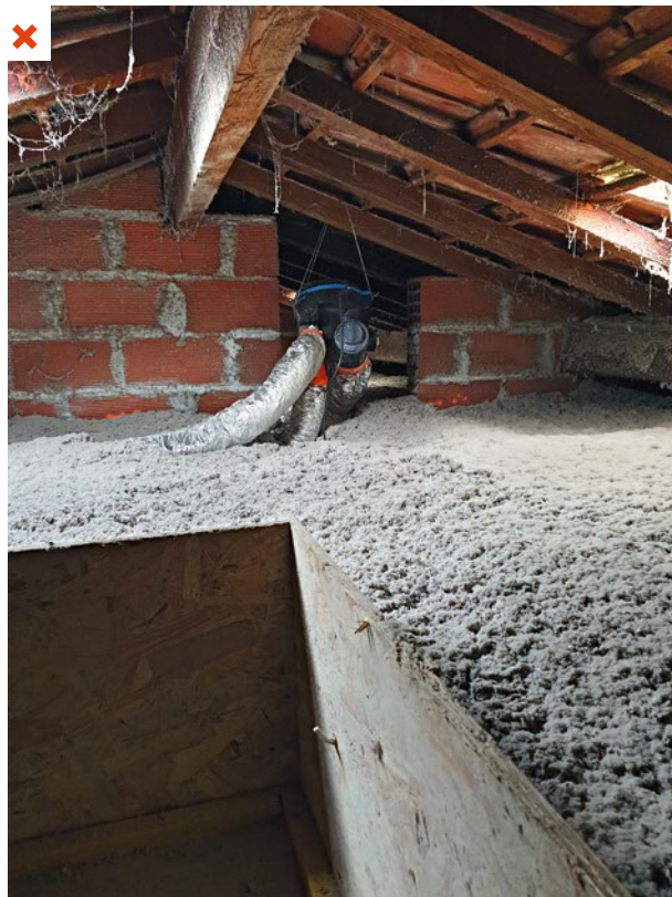
L'absence de cheminement rend difficile l'accès au groupe de ventilation. ©AQC
