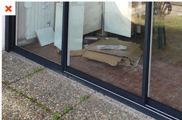
La baie vitrée coulissante est positionnée sur les dalles béton gravillonnées. En cas de fortes pluies, l'eau n'est pas évacuée. L'absence de seuil peut occasionner des infiltrations d'eau à l'intérieur du logement. ©AQC
