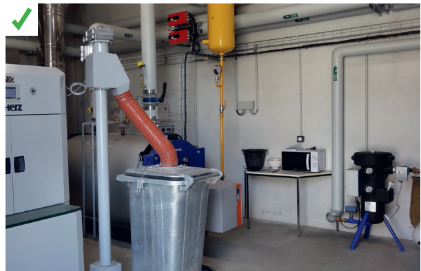
Installation d'un poste de contrôle d'humidité des plaquettes dans le local chaufferie composé d'un micro-onde et d'une balance type pèse-lettre. ©AQC
