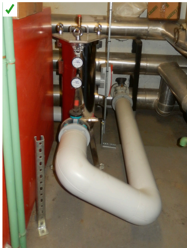
Un filtre magnétique à boue permet de limiter les risques d'embouage du réseau. ©AQC
