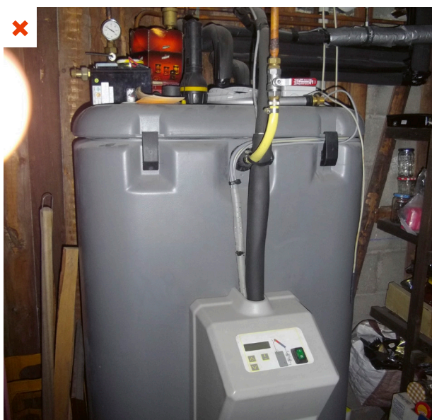
La présence de la chaudière et du ballon d'eau chaude solaire dans le volume chauffé entraîne une élévation de température importante des locaux adjacents. Aucune extraction d'air n'est présente dans ce local technique. ©AQC
