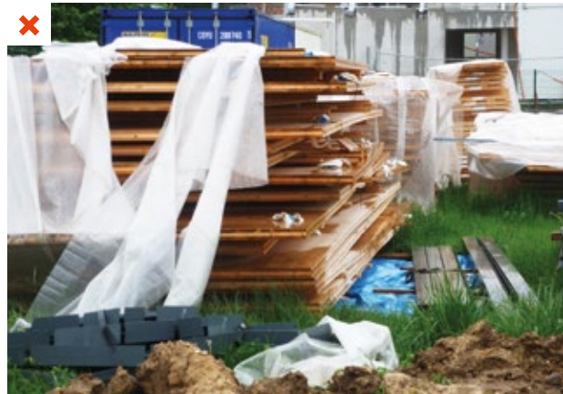
Exemple d'un stockage d'éléments bois mal protégés des intempéries et en contact avec l'humidité du sol. ©AQC
