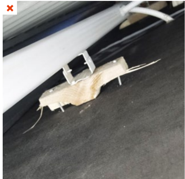
Exemple de détérioration d'une membrane d'étanchéité à l'eau par un opérateur du second œuvre : les pointes servant à fixer les cales qui supportent le réseau électrique percent le pare-pluie. ©AQC
