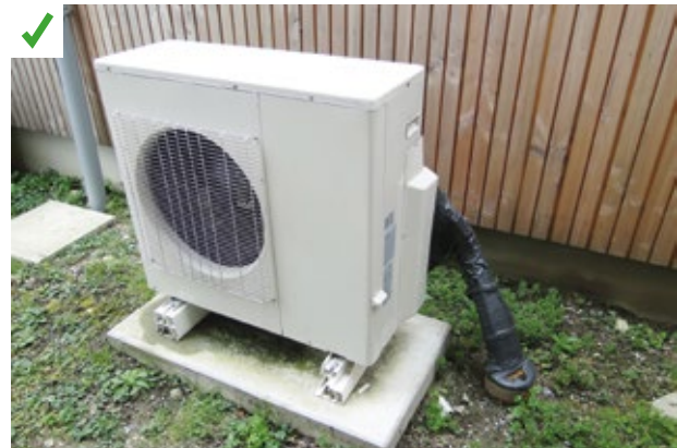
Les réseaux raccordés à cette PAC circulent à travers la dalle afin d'épargner les plans d'étanchéités de l'ossature bois. ©AQC
