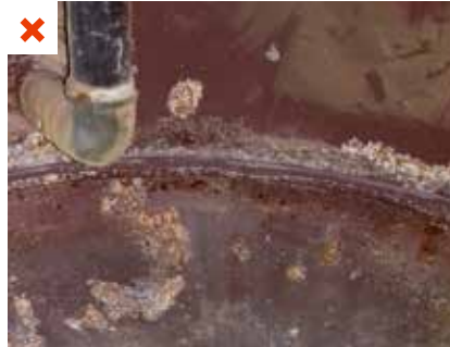
Corrosion interne des ballons de stockage en l'absence de mesures de protection. ©AQC
