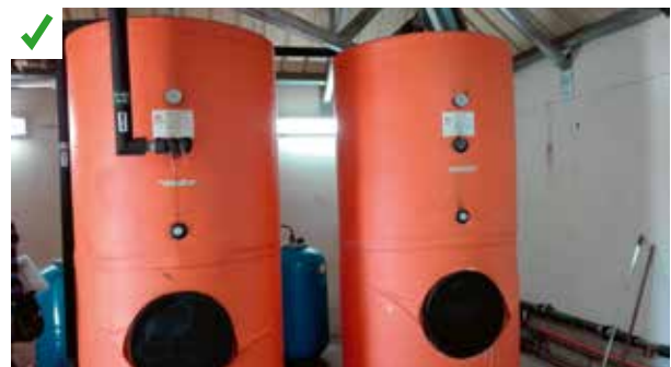
Suite au dimensionnement estimant un besoin de stockage supérieur à 1000 l, le choix s'est porté sur des ballons disposant d'un trou d'homme pour faciliter les interventions de maintenance. ©AQC
