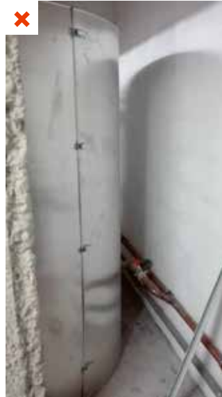
Manque de place disponible dans le local technique pour une intervention préventive ou corrective. Certains accessoires sont difficilement accessibles. ©AQC
