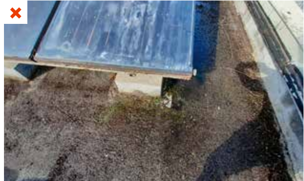
Dégâts dus à une surchauffe des capteurs. ©AQC
