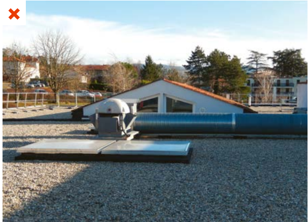
Le bâtiment voisin crée une ombre portée sur le puits de lumière. ©AQC
