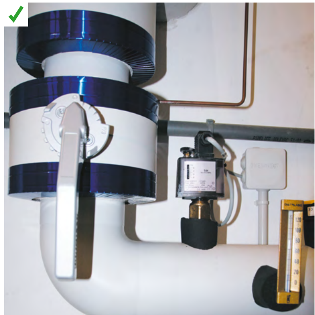
Bonne isolation : corps de vanne isolé et manchons isolants au pied des sondes et thermomètres. ©AQC
