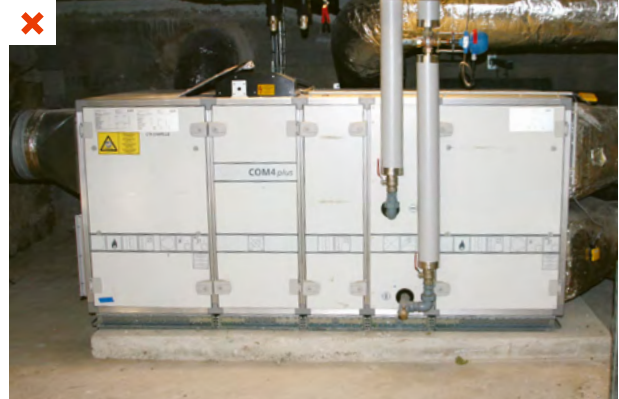
Les CTA sont plus réactives que les systèmes de chauffage à forte inertie. Elles montent vite en température et prennent le pas sur le système de chauffage principal. ©AQC
