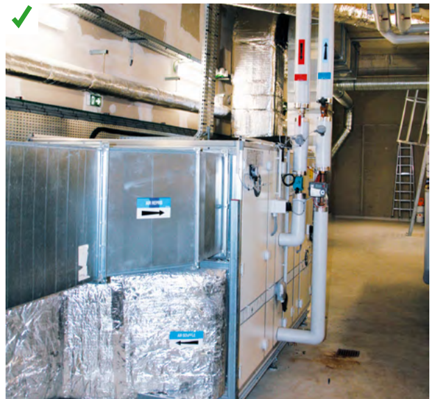
Régulation terminale par vannes deux voies associées à une pompe à débit variable permettant de réduire le débit dans la CTA. Ceci permet également de diminuer la consommation électrique des auxiliaires qui sont moins sollicités. ©AQC
