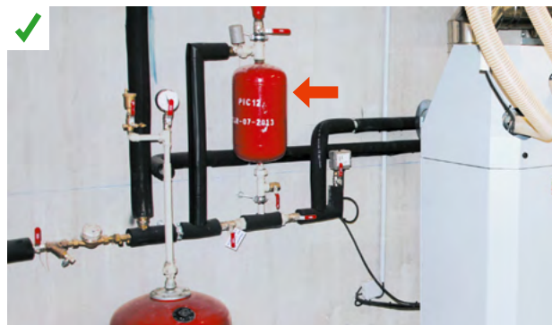
Pot de traitement du circuit primaire. ©AQC
