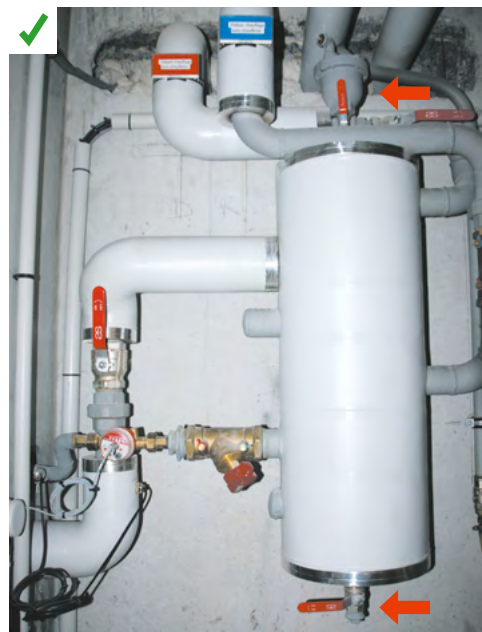
Bouteille casse pression avec purge en partie basse et dégazeur en partie haute. ©AQC
