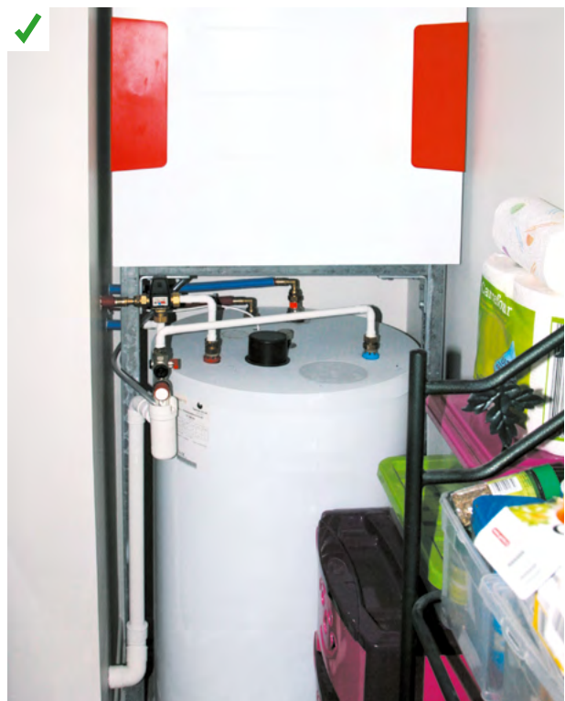
Dans un bâtiment d'habitation collective passif, ce ballon individuel de 150 L est situé très proche du point de puisage. ©AQC
