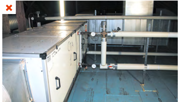
Régulation terminale par vanne trois voies au niveau de la CTA. Tout le circuit en amont est à haute température. ©AQC
