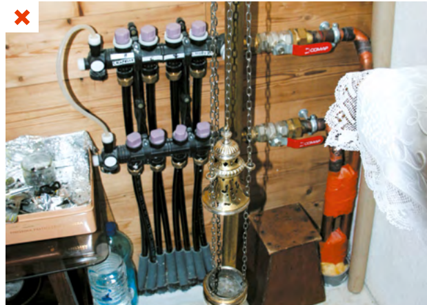
Réseau primaire en cuivre et réseau secondaire du plancher chauffant en PER (situation à risque si le PER est sans barrière anti oxygène). ©AQC
