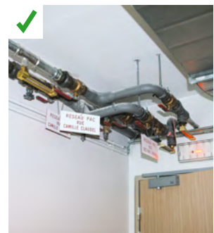
Vannes de boucle hydraulique accessibles dans un local dédié permettant la maintenance aisée sans gêne pour la clientèle. ©AQC
