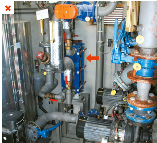
Chaufferie encombrée, accès à l'échangeur à plaque difficile. ©AQC
