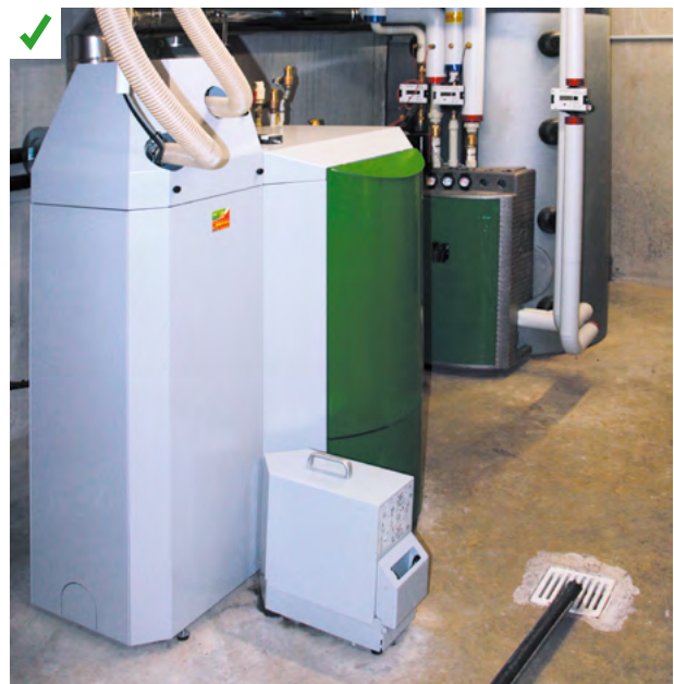
Chaudière à granulés de bois et son ballon d'hydro-accumulation. ©AQC
