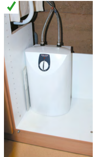
Ballon sous lavabo dans un cabinet de médecin. ©AQC
