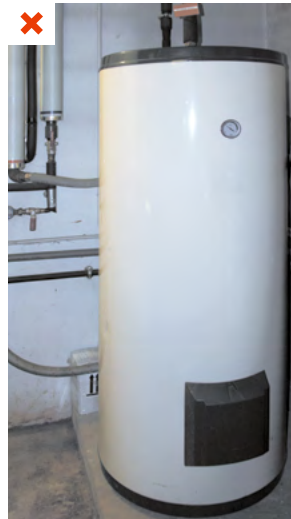
Ballon ECS en chaufferie relié à un long bouclage de distribution imposant le maintien en chauffe des chaudières (2 x 600 kW). ©AQC
