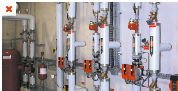
Vannes et circulateurs non isolés. ©AQC
