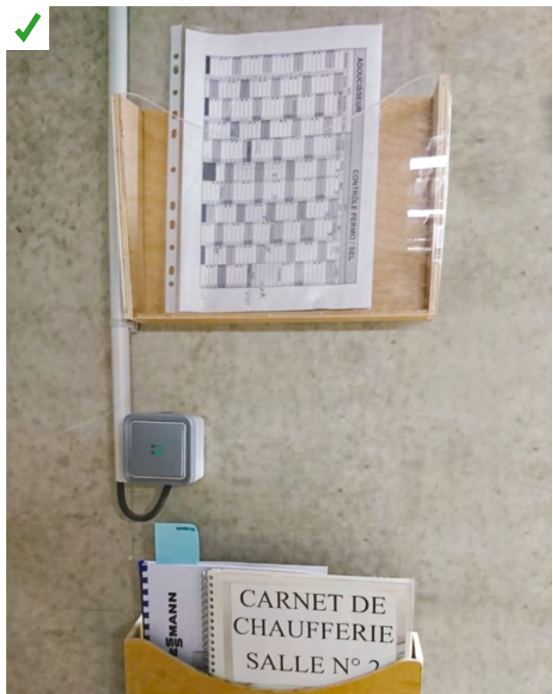
Zone dans la chaufferie dédiée à la gestion des procédures de maintenance. ©AQC
