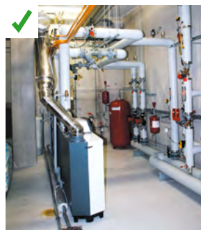
Chaufferie spacieuse, accès à tous les éléments très aisé. ©AQC
