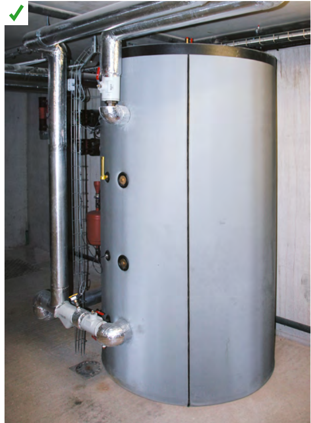
Ballon tampon 3 000 L servant de réservoir de chaleur pour le chauffage et l'eau chaude sanitaire de 18 logements passifs. La chaudière à pellets qui l'alimente a une puissance de 32 kW. ©AQC
