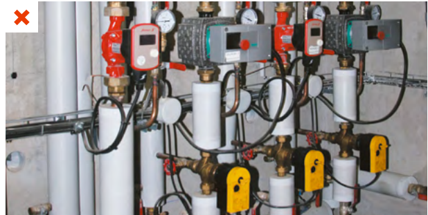
Panoplie d'un bâtiment passif : vannes et circulateurs non isolés. ©AQC
