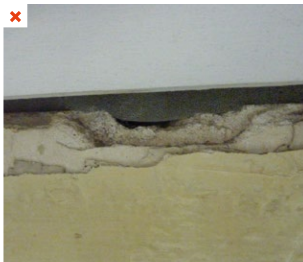
Discontinuité de l'étanchéité due à l'irrégularité du support. ©AQC
