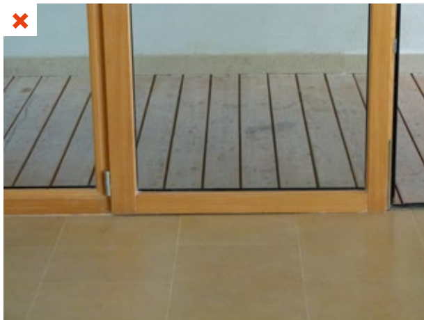
Sous dimensionnement des pommelles qui a conduit à un affaissement de la menuiserie. La porte est difficilement manœuvrable car elle touche le sol. ©AQC
