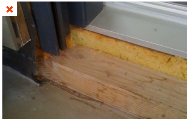
Choix d'un produit inadapté (mousse polyuréthane) ne permettant pas un calfeutrement fonctionnel et durable. ©AQC
