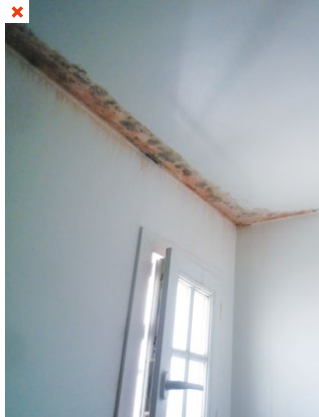
Apparition de phénomènes de condensation importants accompagné du développement de moisissures suite au remplacement des menuiseries anciennes par des menuiseries neuves non munies d'entrées d'air alors que le logement était équipé d'une ventilation simple flux. ©AQC
