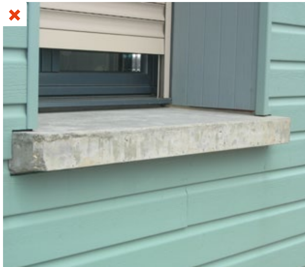
Lors de la rénovation la menuiserie n'a pas été posée dans le même plan que l'isolation (ITE). De plus, l'appui de fenêtre non isolé est à l'origine d'un pont thermique conséquent. ©AQC
