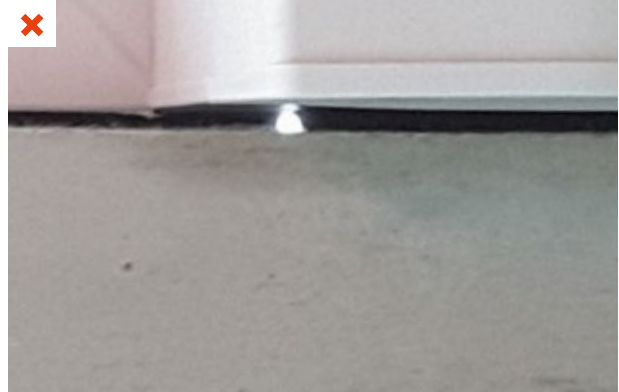
Défaut de raccordement du cordon de mousse imprégnée pré comprimée. ©AQC
