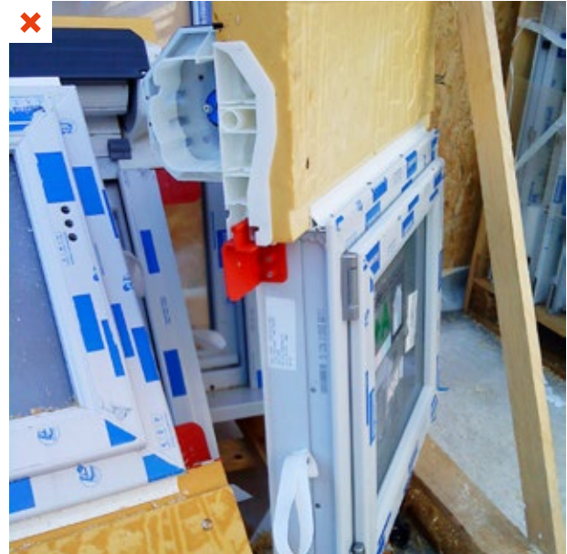
Sur ce chantier, les blocs-baie avec coffres de volets roulants intégrés isolés sont exposés aux intempéries. L'isolant du volet-roulant n'est pas protégé. Il présente des traces d'humidité et la performance du produit est détériorée. ©AQC
