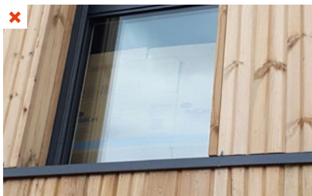
Élément à risque : présence d'un carton comme protection visuelle au niveau de l'allège qui entraîne un écart de température. ©AQC
