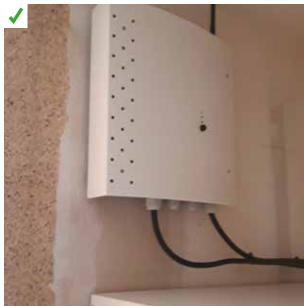
Un régulateur de thermoplongeur a été installé pour produire de l'eau chaude sanitaire avec le surplus de la production. ©AQC
