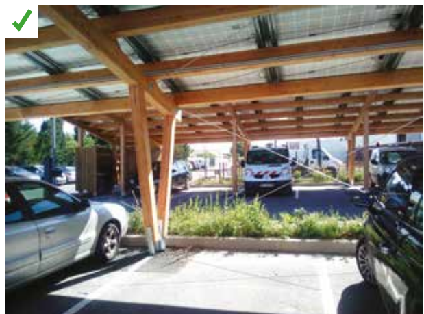
Les panneaux photovoltaïques sont utilisés comme ombrière pour les voitures stationnées. ©AQC
