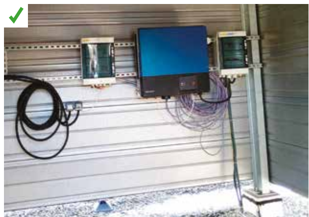
Situé en toiture, ce local est largement ventilé sur sa partie basse, avec un espace d'environ 30 cm sur tout le pourtour du local. Le brassage d'air maintient une température adéquate. ©AQC
