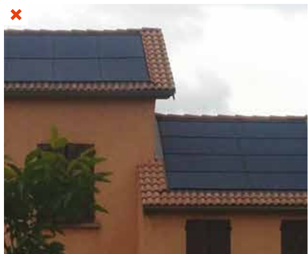
La différence altimétrique des toits crée des ombres projetées l'après-midi sur une partie des panneaux. La baisse de rendement induite n'a pas été anticipée. ©AQC
