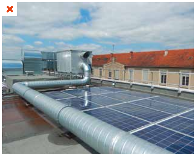
Par manque de place disponible, les panneaux sont positionnés entre l'acrotère et une gaine de ventilation. Ils reçoivent les ombres portées de la gaine sur certaines périodes de la journée. ©AQC
