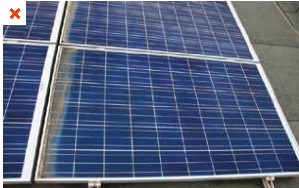
Saleté accumulée sur le dessus des panneaux dont l'inclinaison est quasi-nulle. ©AQC
