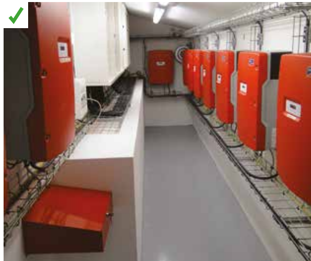
Local dimensionné pour assurer un accès aisé à chaque onduleur. ©AQC
