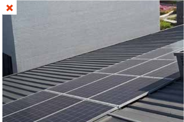
Le bâtiment adjacent à l'installation génère une ombre qui réduit le rendement des panneaux. Ce masque n'a pas été pris en compte lors du dimensionnement. ©AQC
