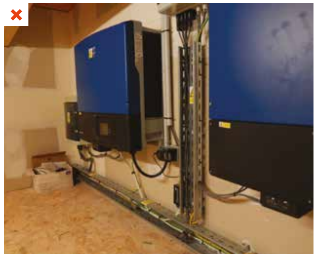
Ce local n'est pas ventilé. Il y a donc une surchauffe importante à l'intérieur pouvant altérer le bon fonctionnement des onduleurs et augmenter le risque d'incendie. ©AQC
