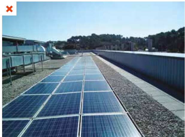
Par manque de place, les panneaux photovoltaïques sont installés à plat. Le rendement est diminué. ©AQC
