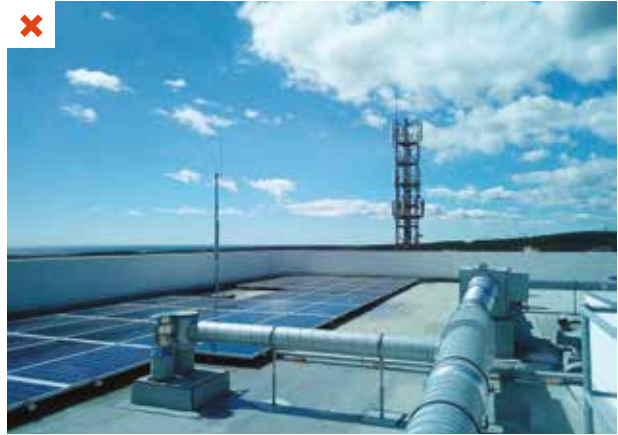
Les gaines de ventilation prennent beaucoup plus de surface que ce qui était prévu en phase conception. Il a été décidé de positionner les panneaux à plat. ©AQC
