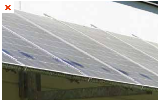
Des restes de fiente, ainsi que la poussière d'un chantier adjacent s'accumulent sur les panneaux. ©AQC
