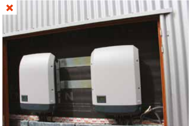
Une porte en tôle métallique, imitant le bardage en façade, ferme le local abritant les onduleurs. Celui-ci n'est pas ventilé et se réchauffe fortement avec le rayonnement direct du soleil sur la porte métallique. Cet apport de chaleur se cumule avec la chaleur produite par les onduleurs. ©AQC
