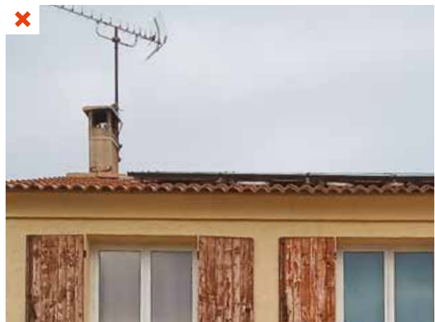
La cheminée projette son ombre sur les panneaux photovoltaïques durant plusieurs heures de la journée. Cet impact n'a pas été pris en compte et aucune disposition particulière n'a été prise. ©AQC
