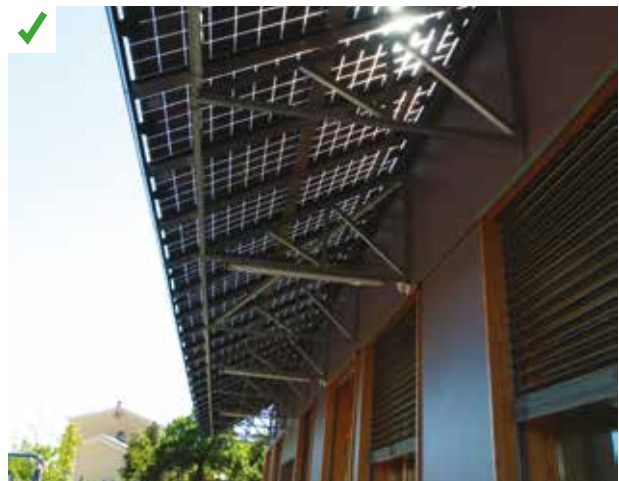
Les panneaux ont une double fonction : production électrique et protection solaire des baies. Cette solution a été retenue en alternative au choix initial d'intégration en toiture. ©AQC
