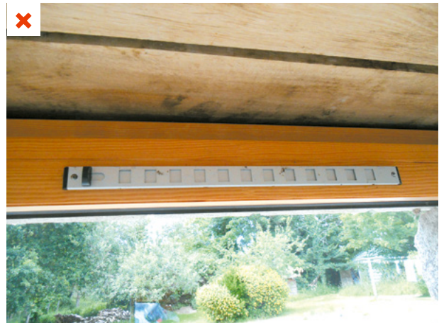
L'absence, la fermeture ou le mauvais dimensionnement des bouches d'entrée d'air frais peut-être responsable de l'accumulation de radon. ©AQC
