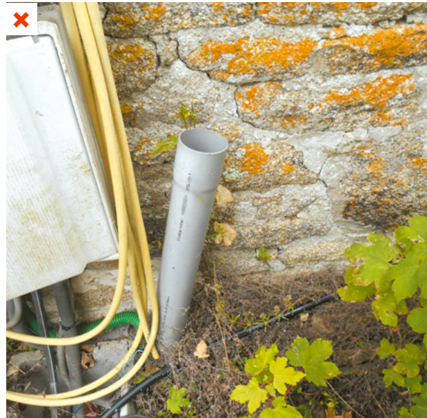
Évacuation inappropriée de l'air chargé en radon. ©AQC
