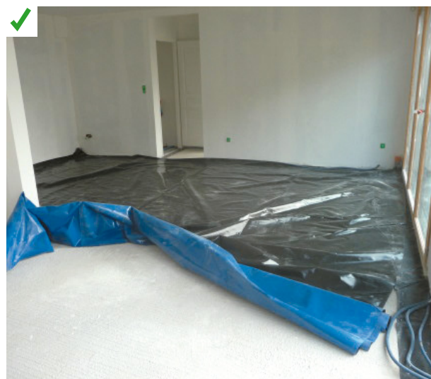
Pose de la deuxième partie de la membrane, sous la chape, une fois l'enveloppe terminée. Cette membrane est raccordée aux lés précédemment mis en œuvre sous les murs. © AQC
