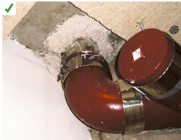
Les défauts d'étanchéité liés au passage des réseaux dans la dalle ont été obturés. © AQC
