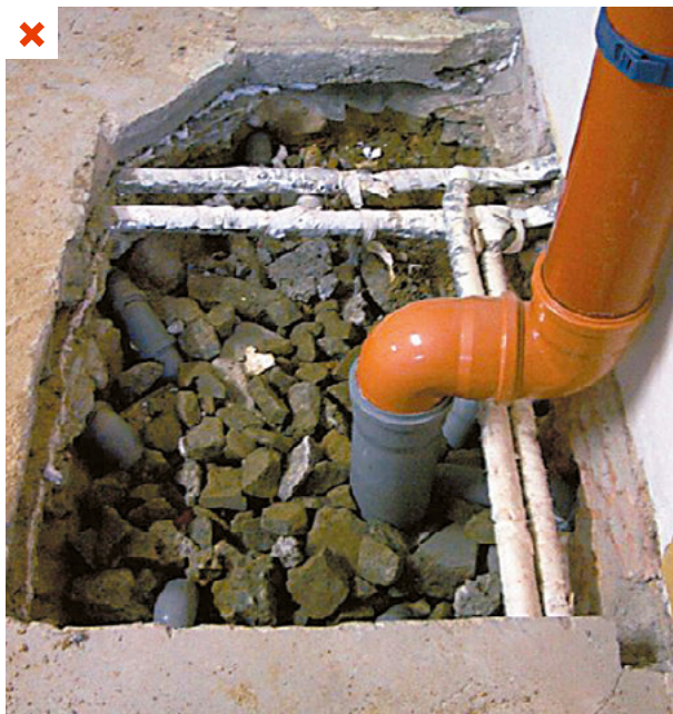
Le passage de la conduite à travers la dalle à l'intérieur du bâtiment n'est pas étanche. ©OFSP
