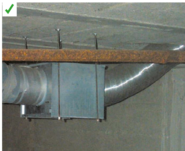
Groupe d'extraction installé dans un vide sanitaire. © CSTB
