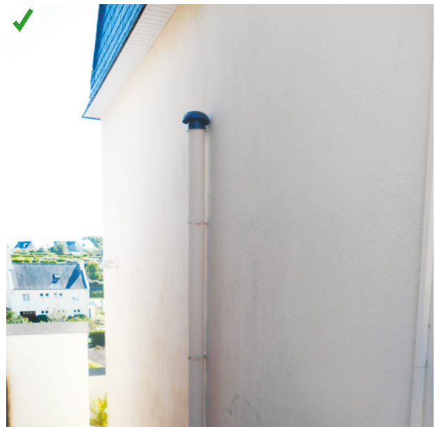
Cheminée d'évacuation adaptée. ©AQC
