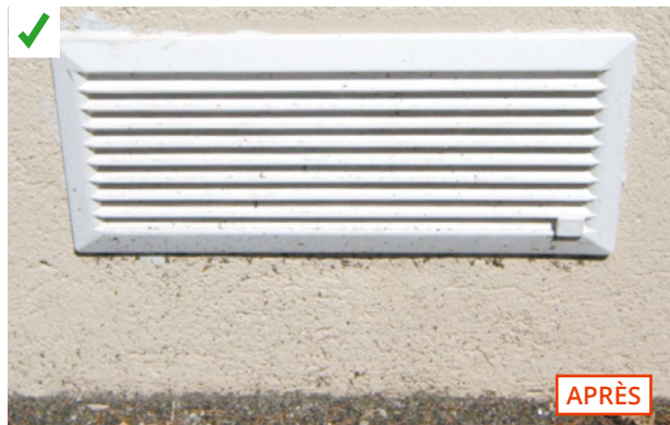
Agrandissement des ouvertures d'un vide sanitaire © AQC
