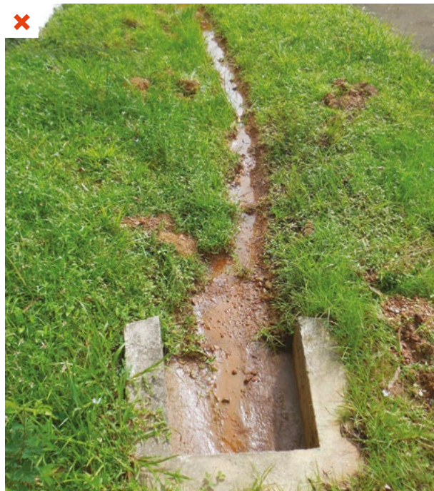
Ouvrage hydraulique sous dimensionné à proximité d'un bâtiment peu surélevé ©AQC
