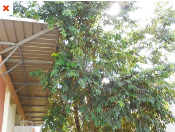
L'absence d'entretien de la végétation entraîne son contact permanent avec les débords de toiture, menaçant ainsi la durabilité de la couverture du bâtiment. ©AQC
