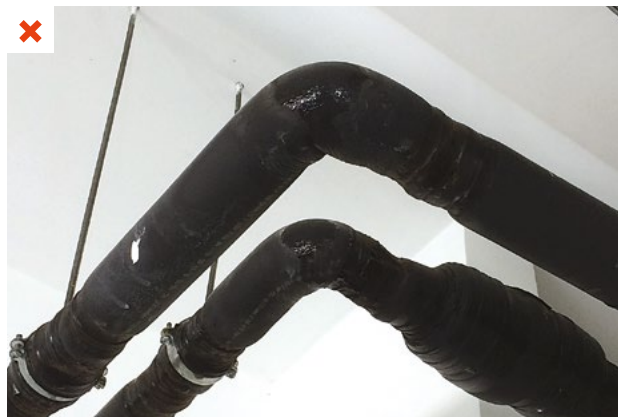
Réseau d'eau glacée présentant des traces de condensation. ©AQC
