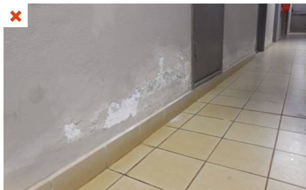
Traces de dégradation en bas de murs liées à des remontées capillaires. ©AQC
