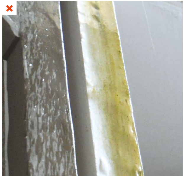
Absence de protection d'une façade exposée à la pluie provoquant la dégradation accélérée des matériaux de structure. ©AQC
