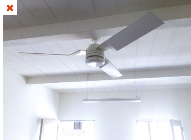
Les usagers n'ont pas été sensibilisés à l'utilisation couplée de la ventilation naturelle du bâtiment et du brasseur d'air. Ce couplage améliore sensiblement le confort thermique. ©AQC
