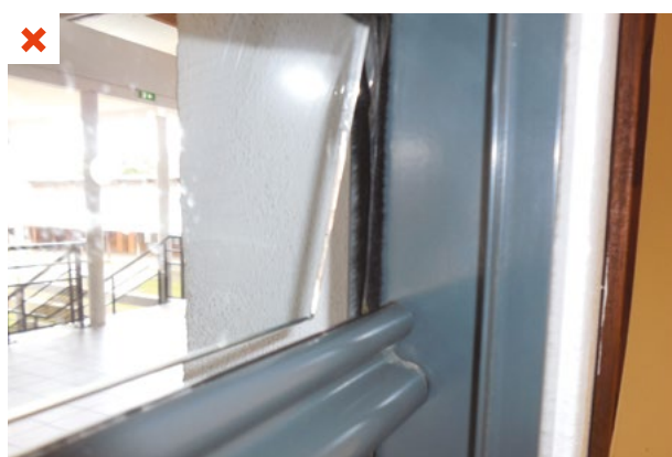
L'usure du mécanisme entraîne une fermeture incomplète des lames des jalousies : défaut d'étanchéité à l'eau en cas de pluie chassée par le vent. ©AQC
