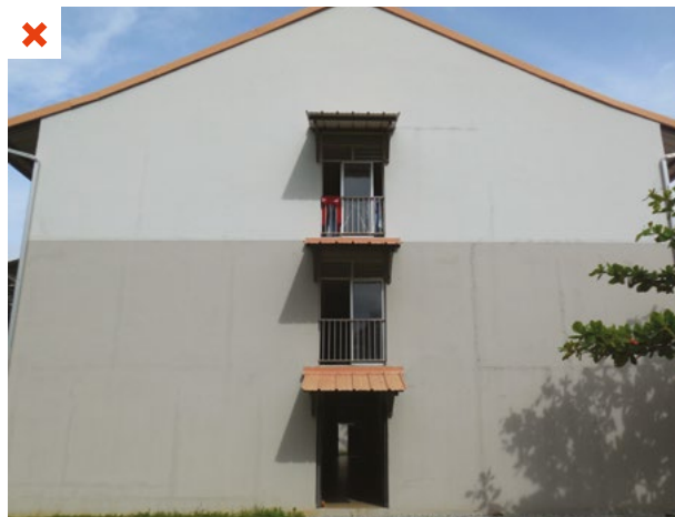
Protections solaires insuffisantes : absence de débord de toiture et sous dimensionnement des casquettes. ©AQC
