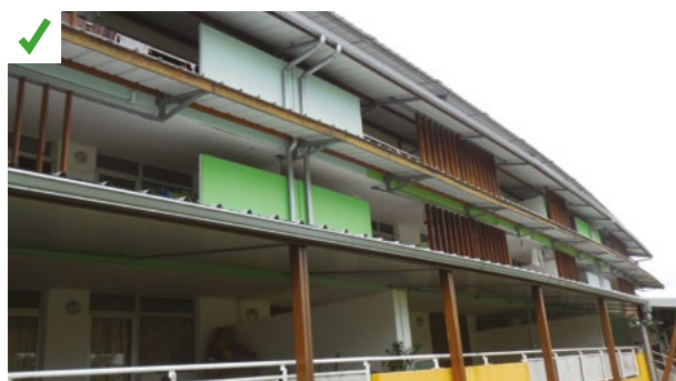
Pose d'auvents limitant l'impact solaire sur les éléments du bâti. ©AQC
