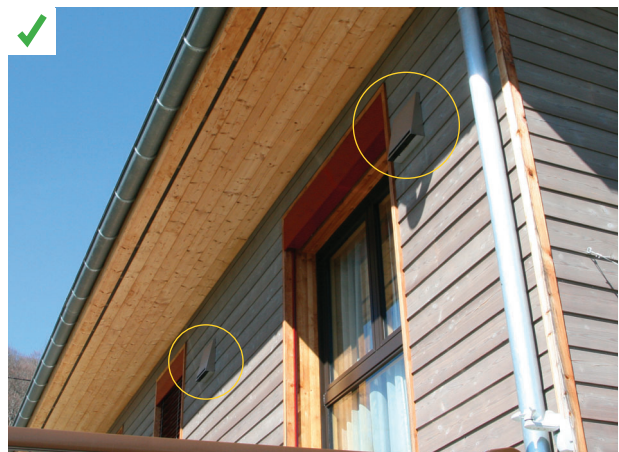
Capot de bouche inox posé sur un bardage à clin grisé en partie haute sous l'avancée de toit. L'intégration des capots est discrète et acceptée par la maîtrise d'ouvrage. ©AQC
