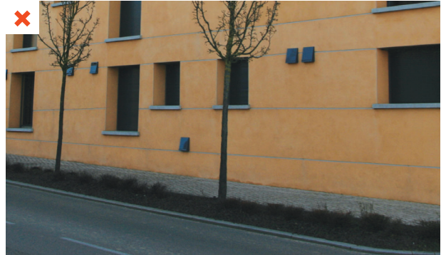
La présence de modules de ventilation sur cette façade entraîne une gêne à l'intérieur des locaux donnant sur la rue très passante. ©AQC
