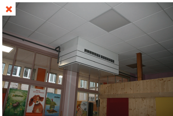
Évacuation des condensats nécessitant une pompe de relevage car le module est suspendu au plafond et placé loin d'un point d'évacuation d'eau usée. ©AQC
