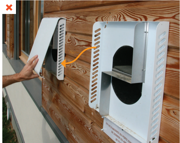
Deux modules identiques, à fonctionnement continu, ont été installés côte à côte. La prise d'air neuf de la bouche au second plan se trouve très proche du rejet d'air (flèche orange) de la bouche au premier plan. ©AQC
