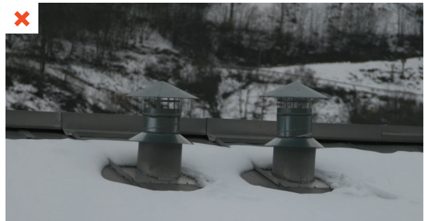
Bouches d'entrée et de sortie d'air en toiture très proches l'une de l'autre. ©AQC
