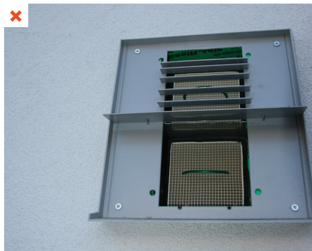
L'accès à l'échangeur/accumulateur nécessite le démontage manuel du capot et le dévissage du support. ©AQC
