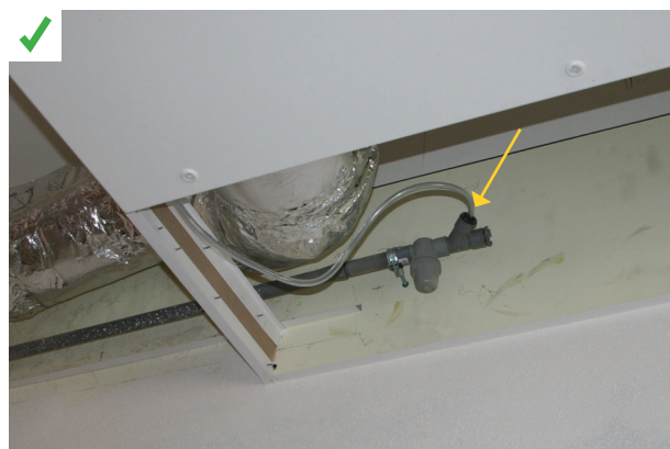
Évacuation gravitaire des condensats vers une canalisation d'eau usée (lavabo présent dans la salle de classe). ©AQC
