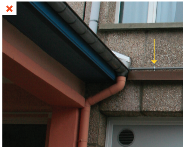
L'évacuation des condensats se fait en extérieur vers une descente d'eau pluviale. L'eau de condensation a gelé dans la canalisation qui s'est bouchée. ©AQC
