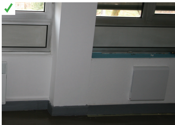
Le module de la ventilation double flux décentralisée est positionné en allège (à droite sur la photo). Le flux d'air est dirigé parallèlement au mur. Aucune gêne par courant d'air n'est ressentie par les usagers.
