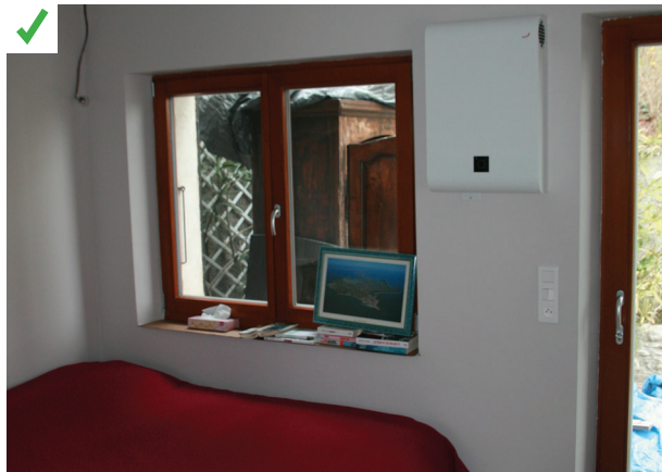
Le module de la ventilation double flux décentralisée est à hauteur d'homme et proche du lit. Une attention particulière a été apportée pour diriger le flux d'air neuf à l'opposé du lit pour ne pas créer d'inconfort.
