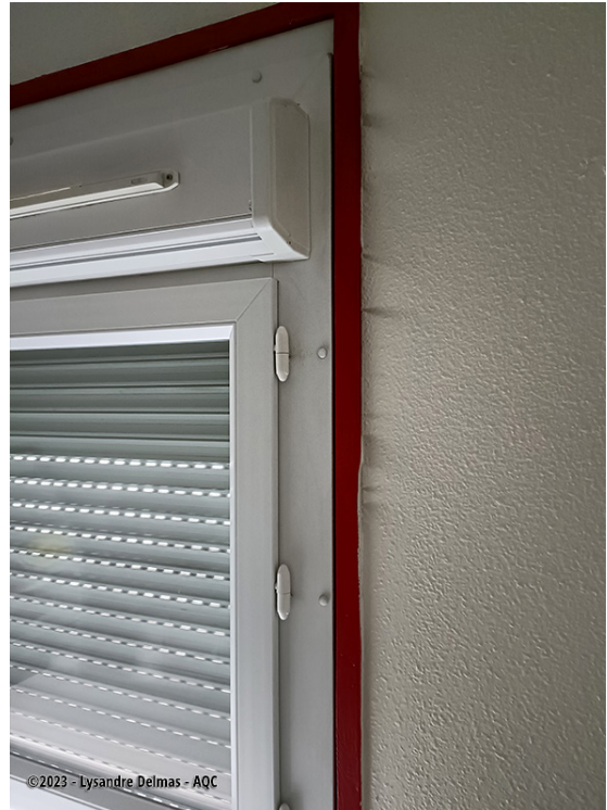
Apparition de « moustaches » matérialisant des défauts d'étanchéité à l'air autour d'une fenêtre.
