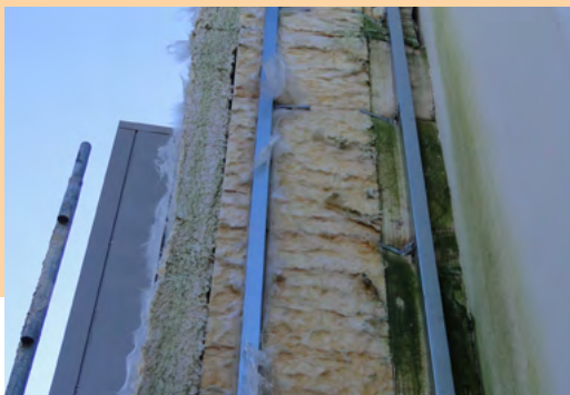
Matériaux dégradés par exposition aux intempéries © Crédit : AQC
