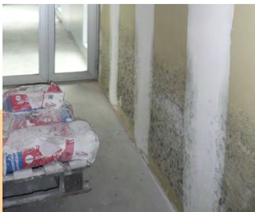
Développement de moisissures engendré par le confinement d'air humide après la réalisation des chapes fluides
