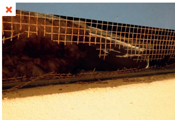
Grille de protection antinuissibles détériorée. ©AQC
