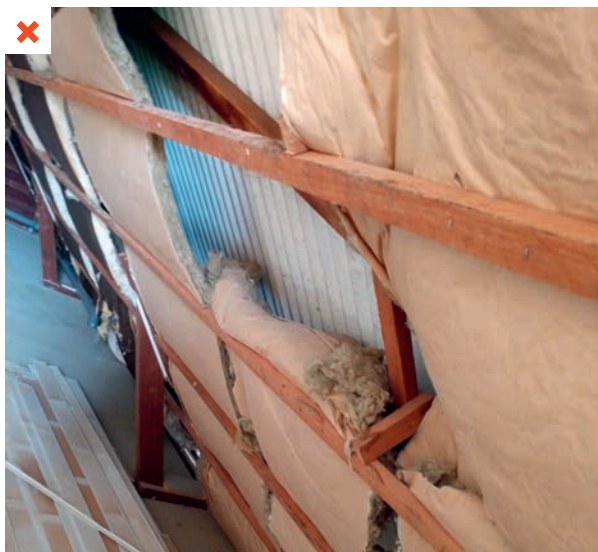
Isolation sous rampant ayant glissé. ©AQC
