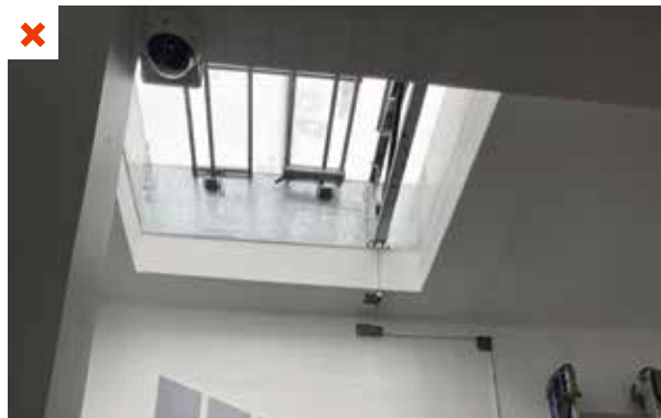
Trappe de désenfumage sans protection solaire. ©AQC
