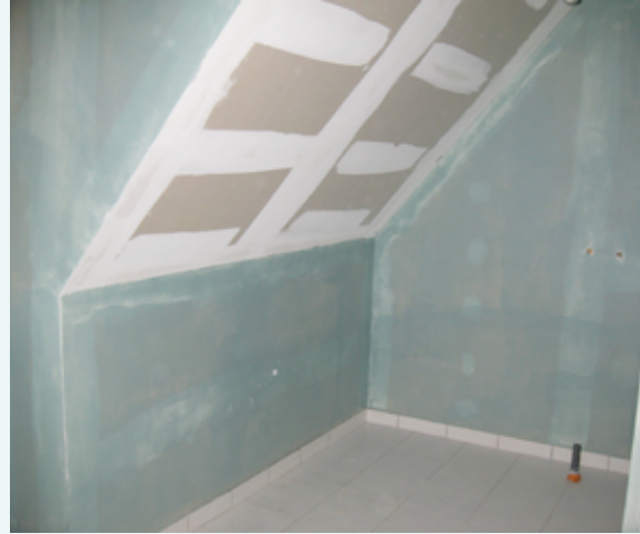
4. Défaut de support : plaques de plâtre cartonnées non hydrofuges ("standard") avec un primaire (sans SPEC) (© EURISK)
