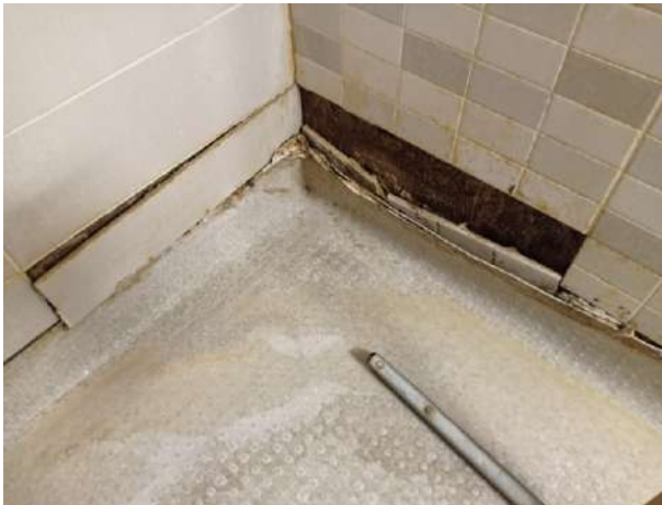
7. Défaut de raccordement entre sol et paroi murale d'une douche sans receveur (© SOCATAT)
