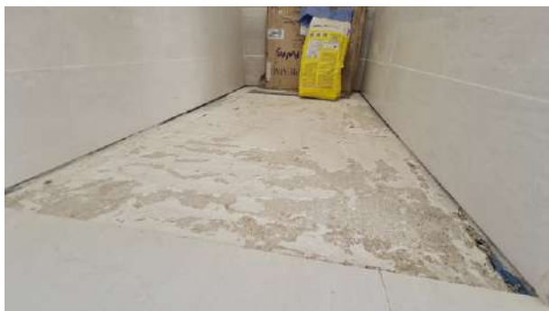
13. Absence de réservation pour la réalisation d'une douche de plain-pied (© SOCABAT)
