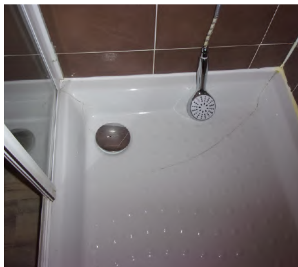
3. Fissuration d'un receveur de douche (© SARETEC)
