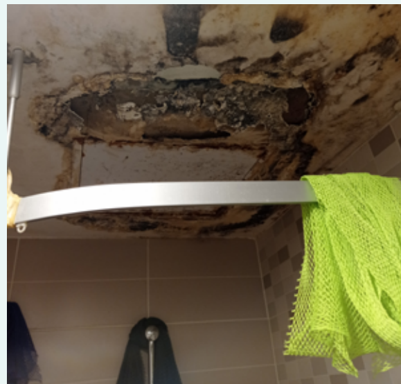
6. Défaut d'étanchéité de la douche de l'étage supérieur (© SOCATAT)
