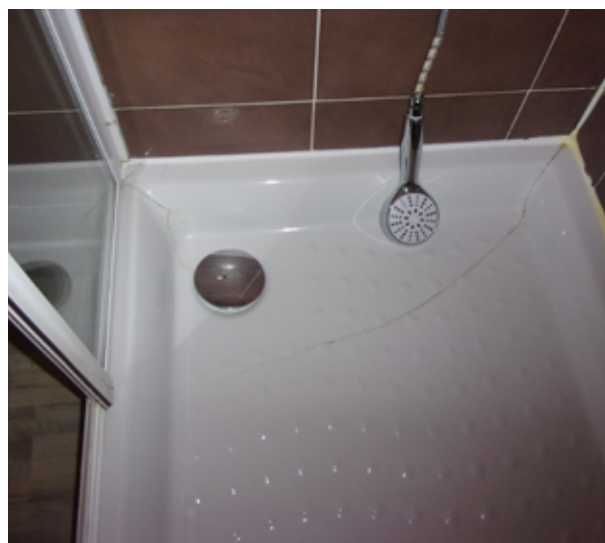
3. Fissuration d'un receveur de douche (© SARETEC)
