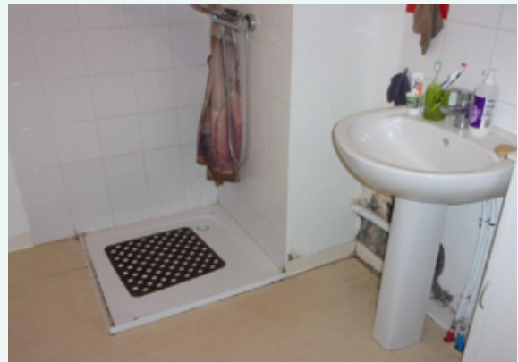
5. Absence de pare-douche (© SARETEC)
