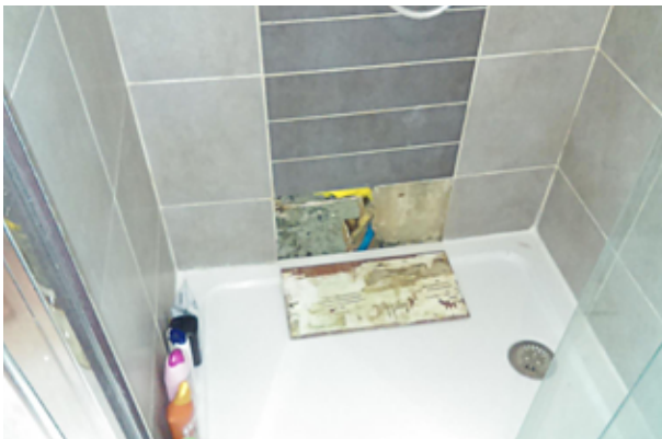
8. Défaut d'adhérence d'un revêtement mural de douche (© SARETEC)
