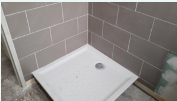
11. Défaut de pose d'une douche (receveur mis en œuvre après le revêtement mural) (© SOCABAT)
