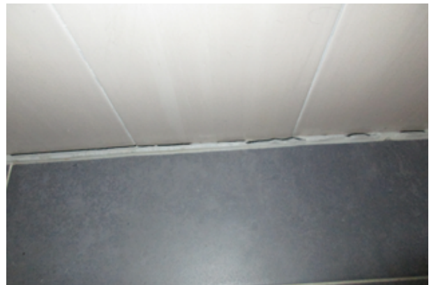
10. Défaillance d'un joint "d'étanchéité" en pied de paroi verticale à sa jonction avec le sol d'une douche sans bac (© EURISK)
