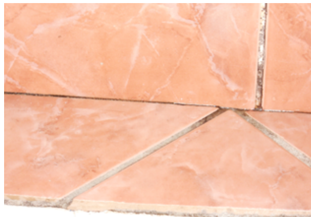
12. Défaut de mise en œuvre du revêtement de sol (absence de joint entre sol et mur) (© SOCABAT)
