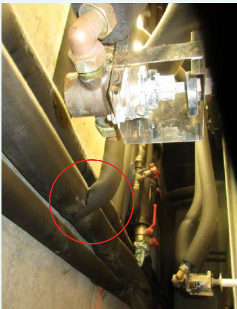
1. Fuite sur l'alimentation d'une douche (© EURISK)
