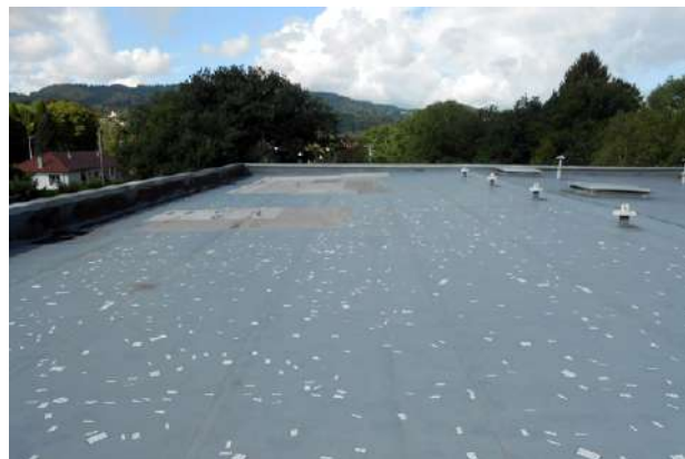
Revêtement d'étanchéité percé par la grêle © AQC
