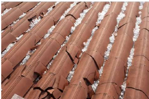
Tuiles cassées par la grêle (exemple de tuiles non françaises) © AQC
