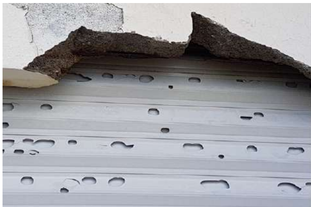
Volet roulant en PVC impacté par la grêle © AQC
