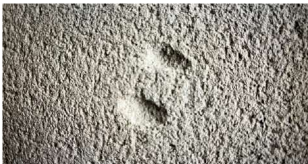
Enduit de façade impacté par la grêle © AQC
