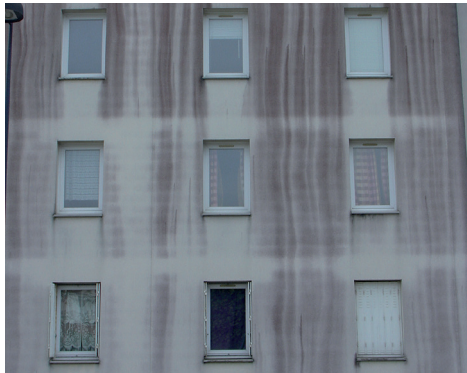
Colonisation de la façade par des algues rouges © AQC
