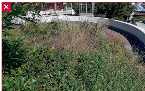
Absence de protection collective de type garde-corps et point d'ancrage isolé sans ligne de vie et peu visible dans la végétation. © AQC
