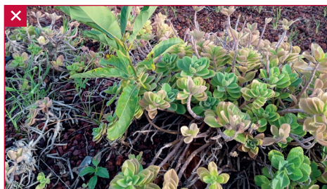
Développement d'une jeune pousse d'arbre d'avocatier marron dont les racines risquent rapidement de dégrader le dispositif d'étanchéité à l'eau de la toiture. © AQC
