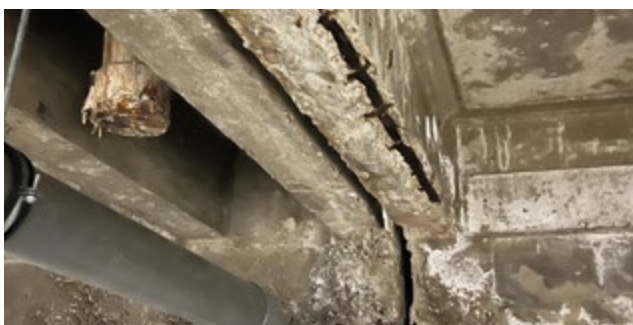
Figure 15 : Exemples d'armatures fortement dégradées avec éclatement du béton d'enrobage suite à des infiltrations dans un parking (source R. Mège).
