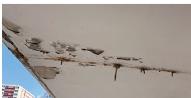
Figure 19 : Exemple d'infiltration à travers l'épaisseur de la dalle des balcons (source R. Mège).
