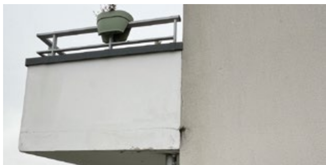
Figure 18 : Exemple de balcon récent avec la dalle ancrée dans le plancher du bâtiment. Fissure horizontale à faible risque à la jonction entre le garde-corps maçonné et la dalle du balcon. Fissure verticale à risque plus important à la jonction entre la façade et le garde-corps maçonné (source R. Mège).
