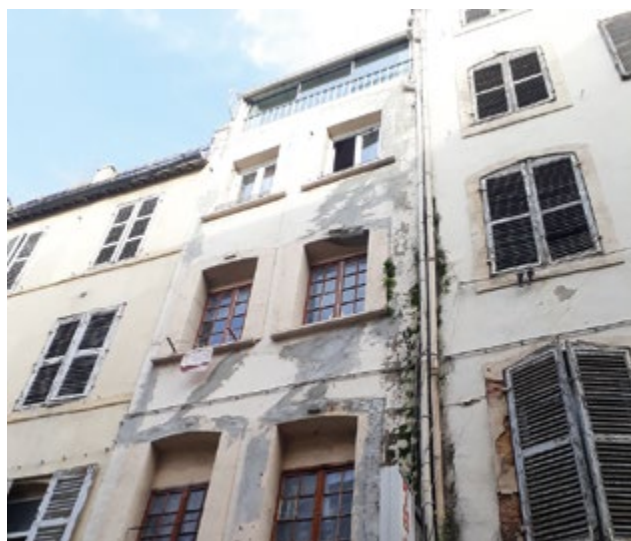
Figure 6 : Exemple de fissures présentes en façade à tous les étages (Source : R. Mege).
