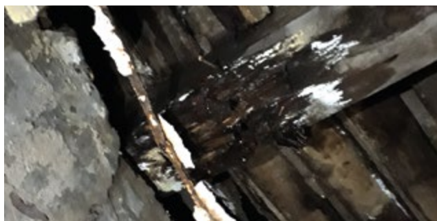
Figure 20 : Exemple d'encastrement de poutre en bois très dégradé suite à des remontées capillaires créées par l'étanchéification d'un mur de cave (source : R. Mège).
