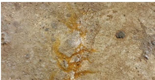
Figure 16 : Traces de rouille apparues au niveau d'une fissure où s'infiltrait de l'eau. Signe de corrosion des armatures présentes dans l'épaisseur du béton armé (source : R. Mège).
