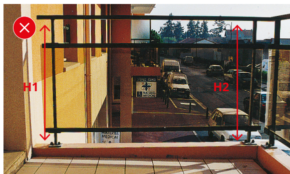
5. Hauteur H1 insuffisante
